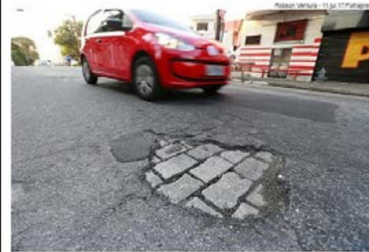
Buraco na rua Ibirama, na Vila Prudente. TCM manda empresas taparem 6.862 buracos em São Paulo
