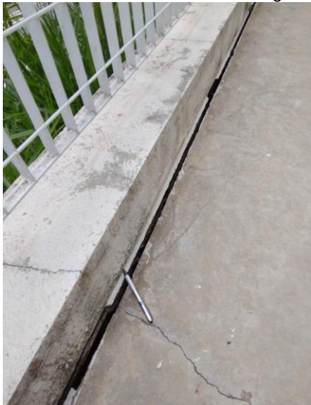
Foto 7 - Detalhe da abertura longitudinal entre o piso de concreto do passeio lateral e a grade/mureta
