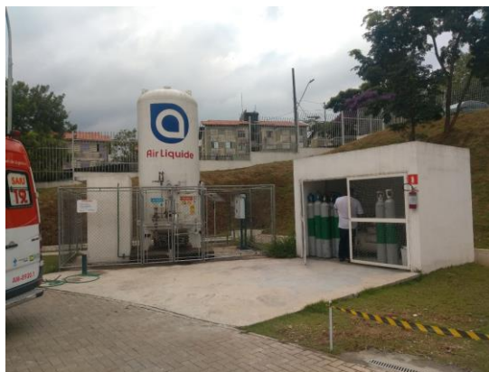
Foto 6 - ABRIGO DO COMPRESSOR DE GÁS MEDICINAL
