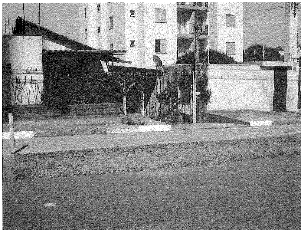
Foto 05 – Buraco antes do início do serviço (previamente requadrado)
