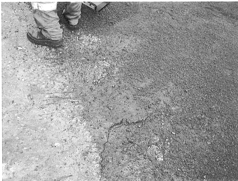
Foto 06 – Aplicação indevida de concreto asfáltico sobre piso sem requadramento
