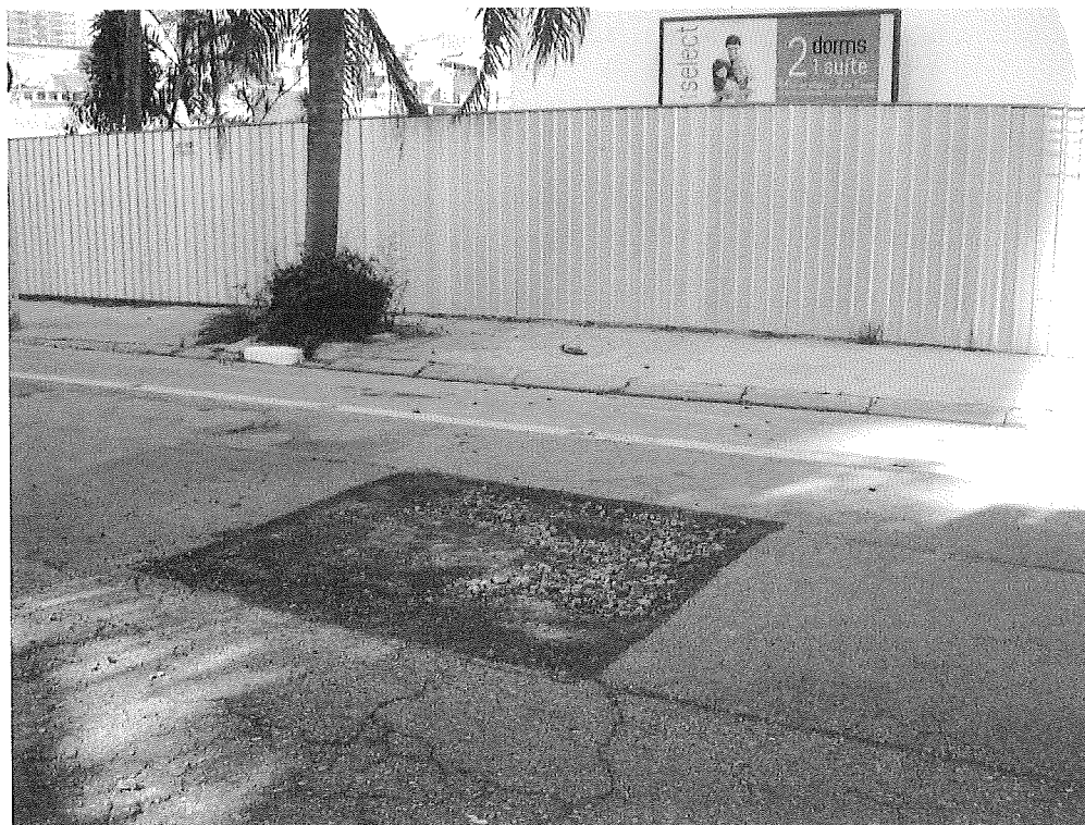
Foto 17 – Buraco antes do início do serviço (previamente requadado)
