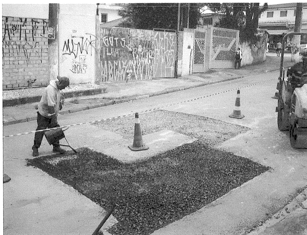
Foto 14 – Realização inadequada da pintura de ligação
