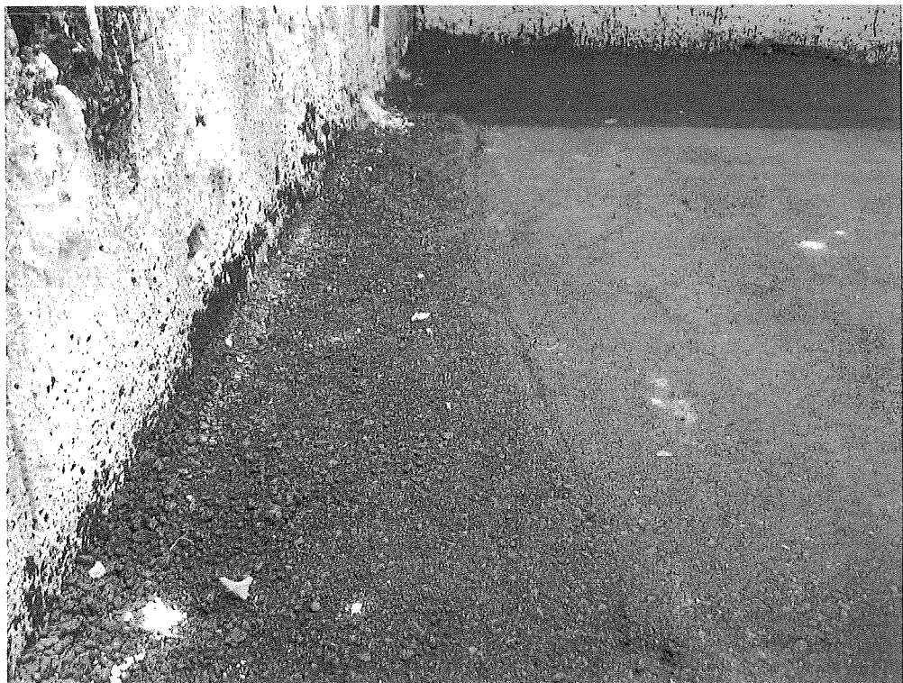
Foto 10 – Compactação inadequada dos cantos
