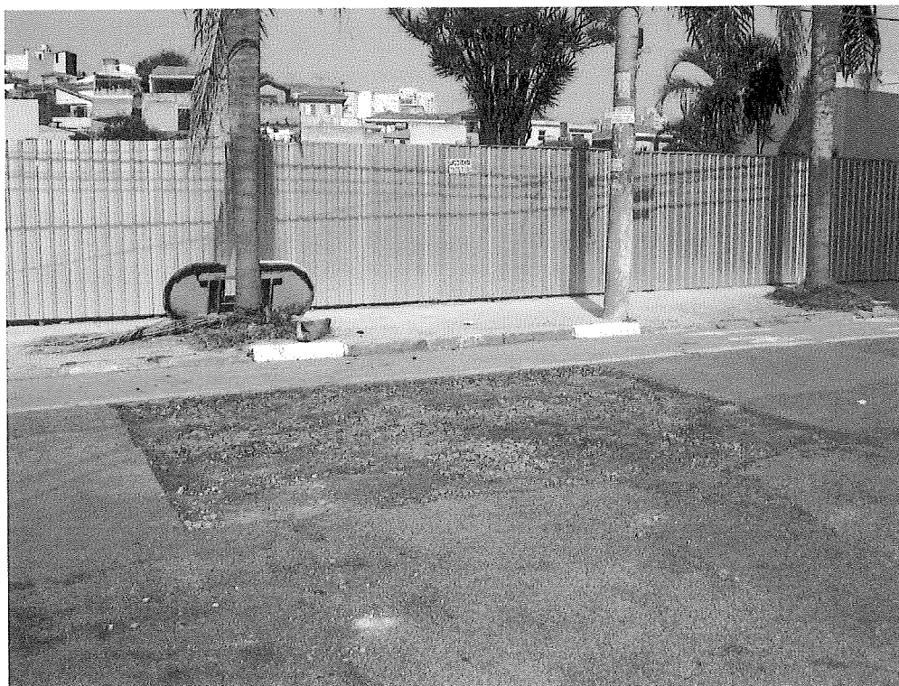
Foto 11 – Buraco antes do início do serviço (previamente requadrado)
