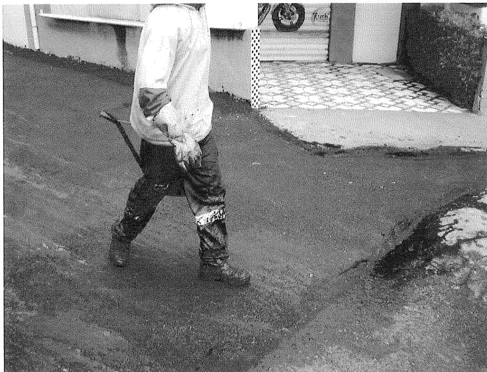
Foto 11 – Aplicação inadequada de pintura de ligação
