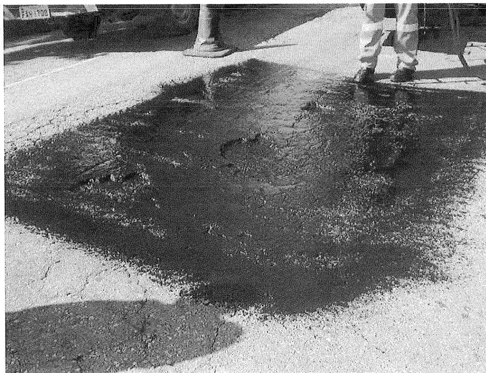
Foto 04 – Ausência de requadramento do buraco (Buraco 1)
