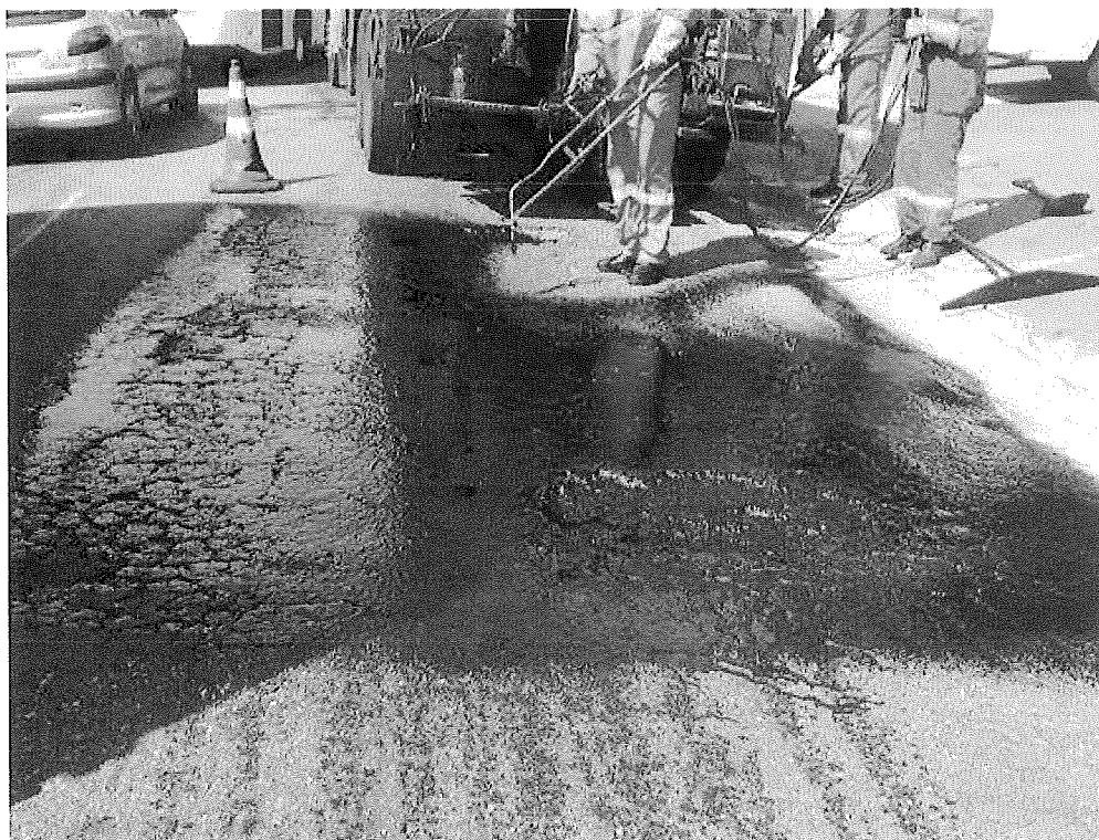
Foto 08 – Ausência de requadramento do buraco (Buraco 2)
