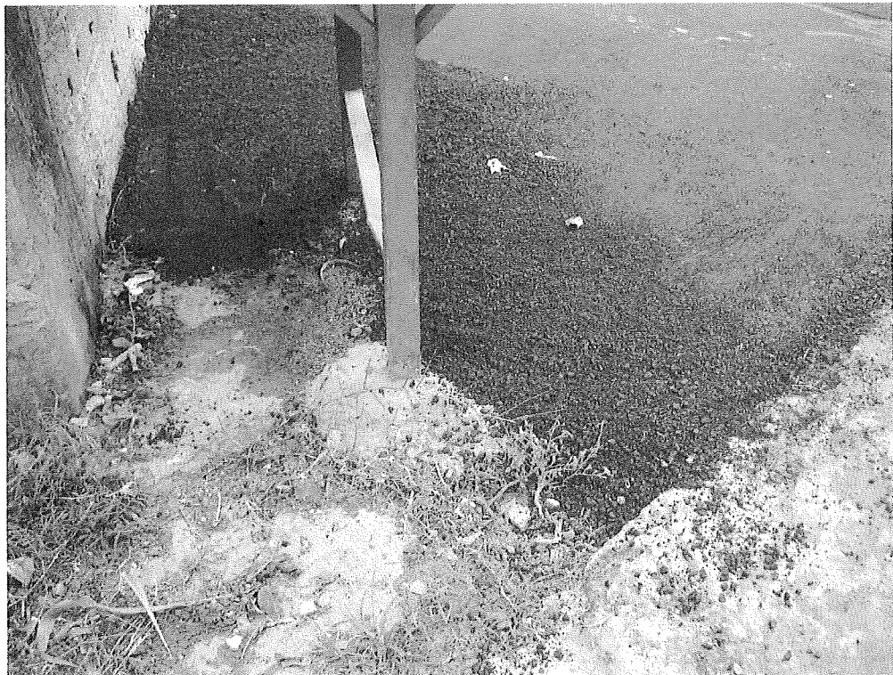
Foto 09 – Aplicação indevida sobre solo e compactação inadequada dos cantos
