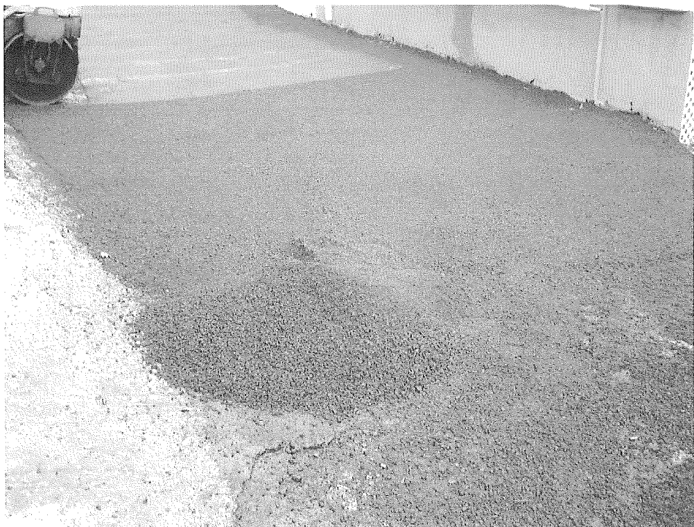
Foto 08 – Aplicação indevida de concreto asfáltico sobre piso sem requadramento
