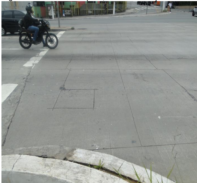
Figura 3 - Radar do Grupo B, detalhe de Laço indutivo inserido em cortes no pavimento.
