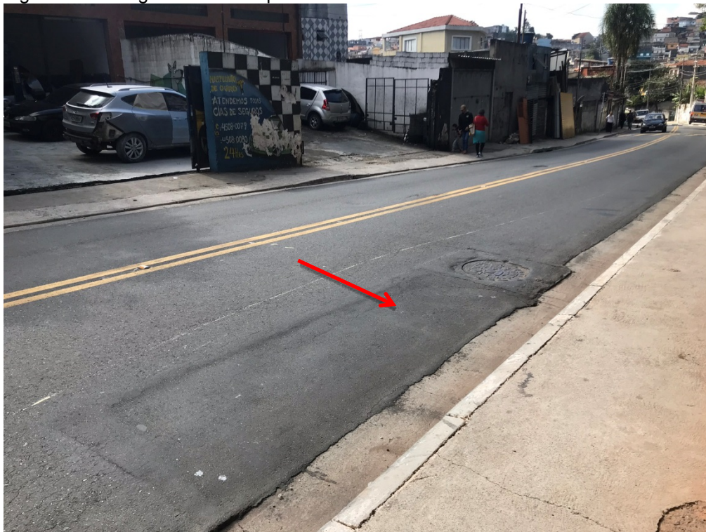
Figura 103 - Irregularidades no pavimento.
