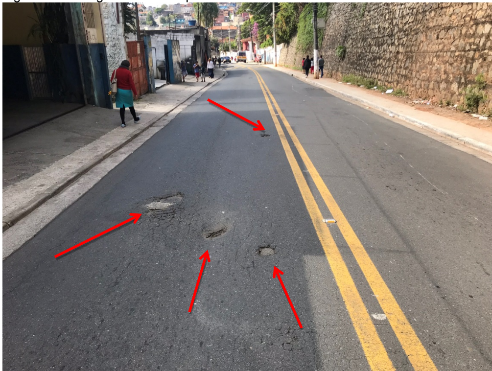
Figura 101 - Irregularidades no pavimento.
