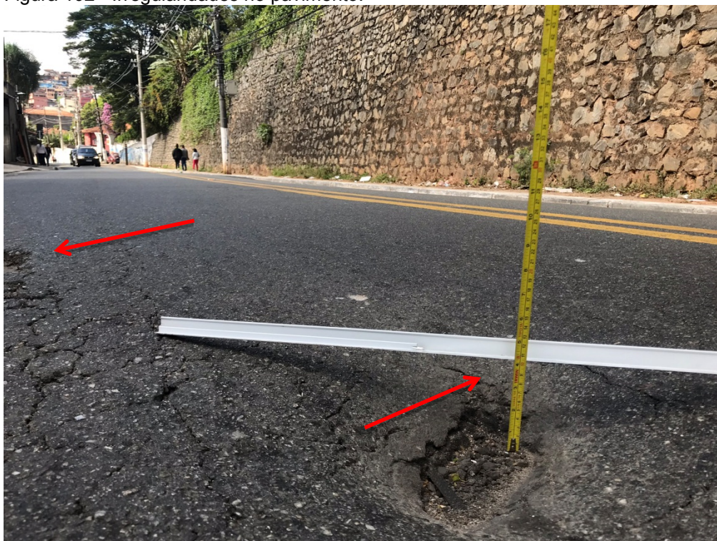
Figura 102 - Irregularidades no pavimento.
