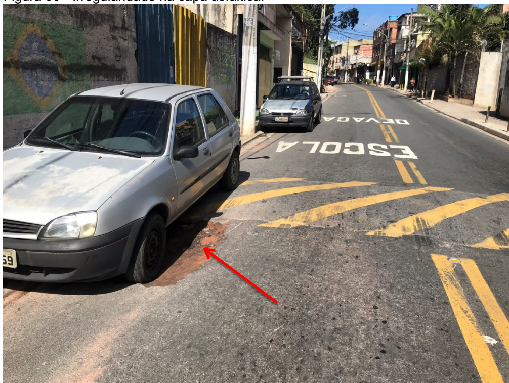
Figura 90 - Irregularidade na capa asfáltica.
