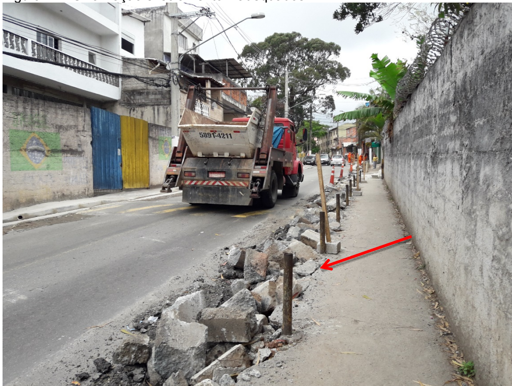
Figura 14 - Sinalização e isolamento inadequados.
