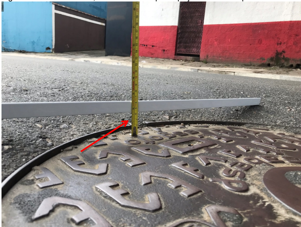
Figura 67 – Desnível de 4,0 cm entre a tampa de poço de visita e o pavimento.
