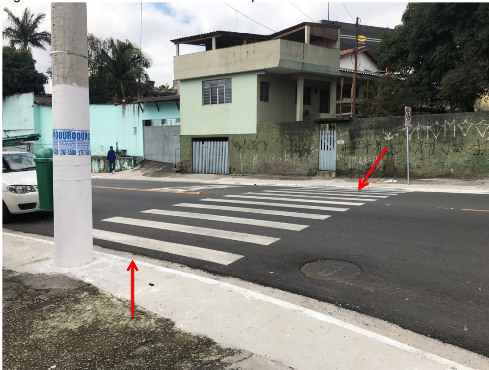
Figura 69 - Ausência de rebaixamento dos passeios nas travessias sinalizadas.
