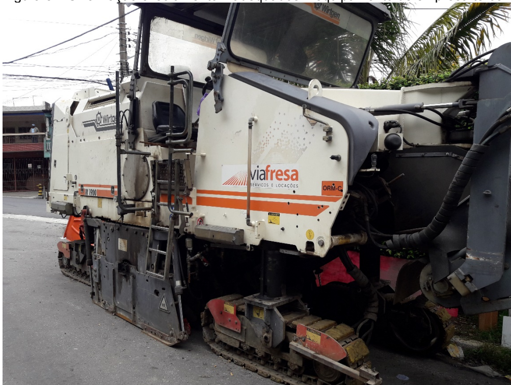
Figura 8 – Sinalização e isolamento inadequados – equipamento de empresa terceirizada.
