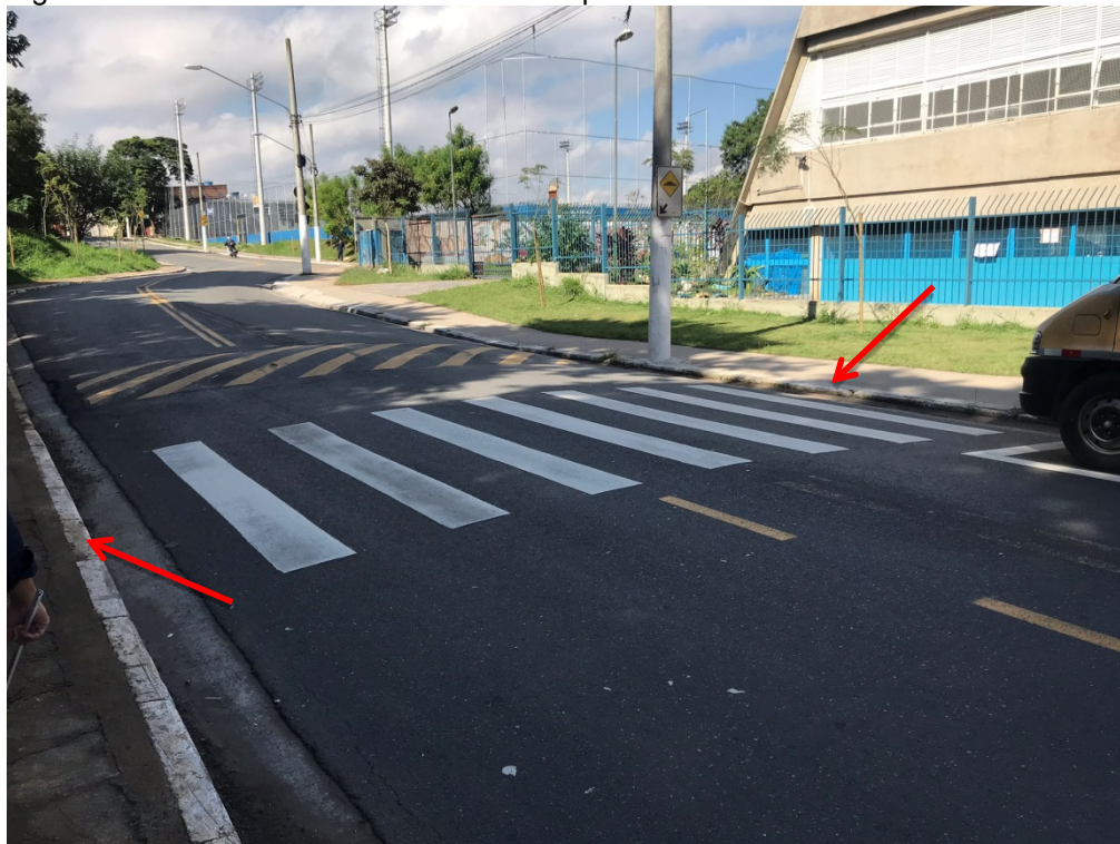
Figura 83 – Ausência de rebaixamento dos passeios nas travessias sinalizadas.
