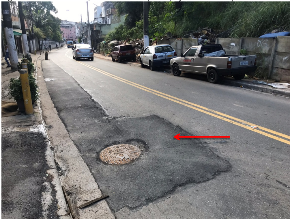
Figura 87 - Desnível de 4,0 cm entre a tampa de poço de visita e o pavimento.
