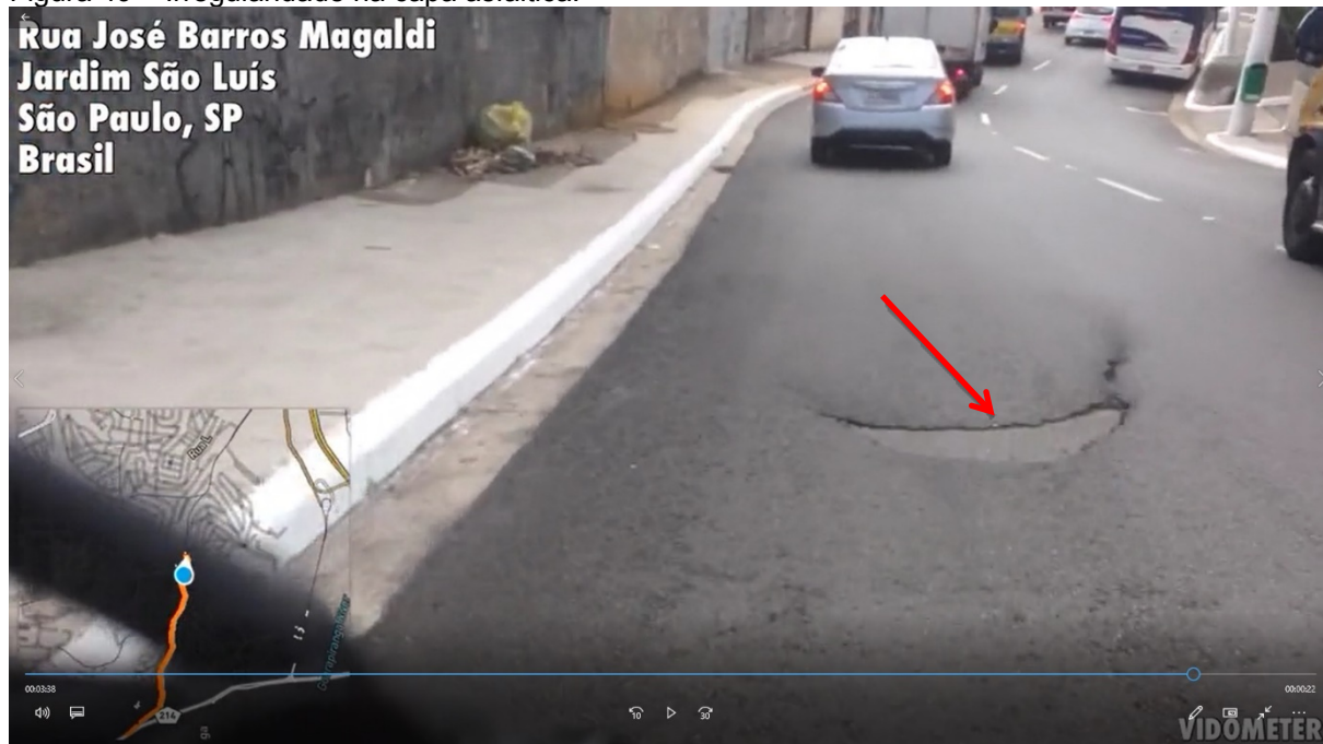
Figura 49 – Irregularidade na capa asfáltica.
