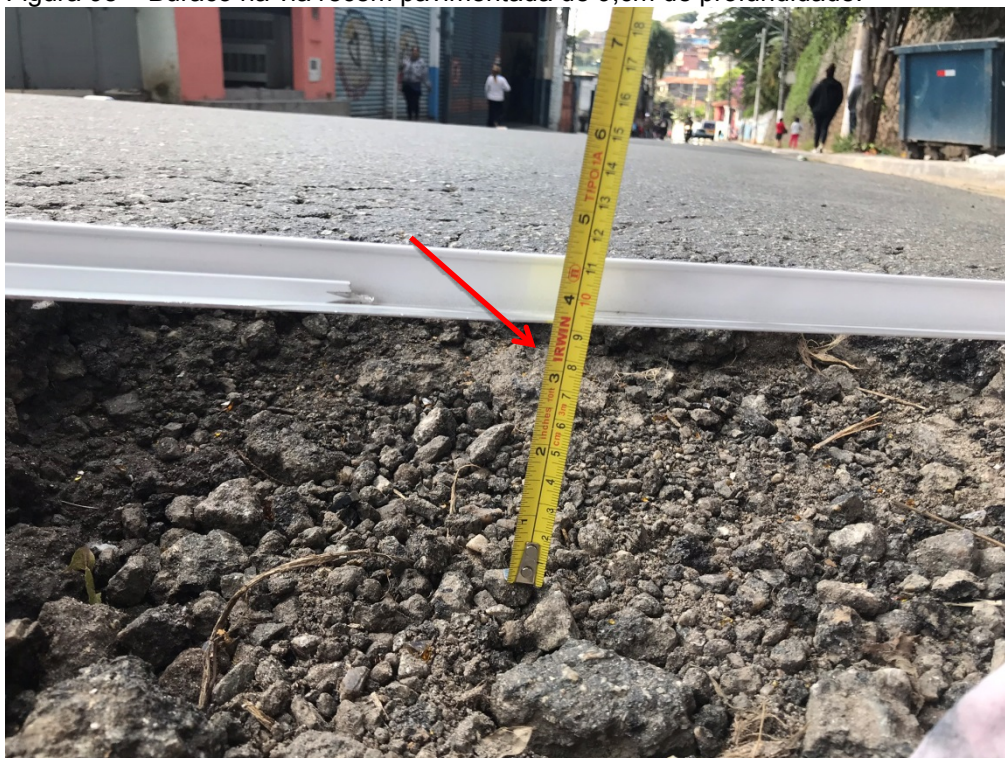
Figura 98 – Buraco na via recém pavimentada de 9,cm de profundidade.
