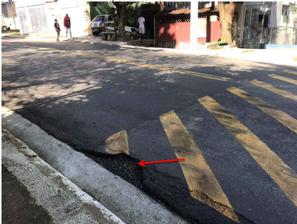
Figura 85 - Irregularidade na capa asfáltica.
