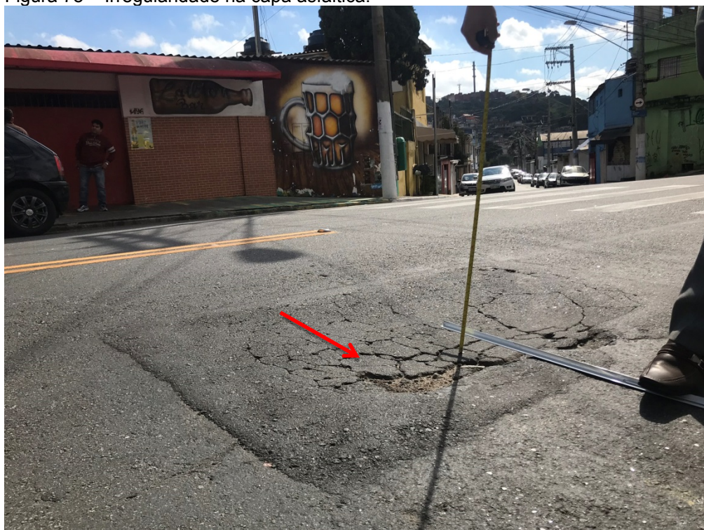
Figura 78 – Irregularidade na capa asfáltica.
