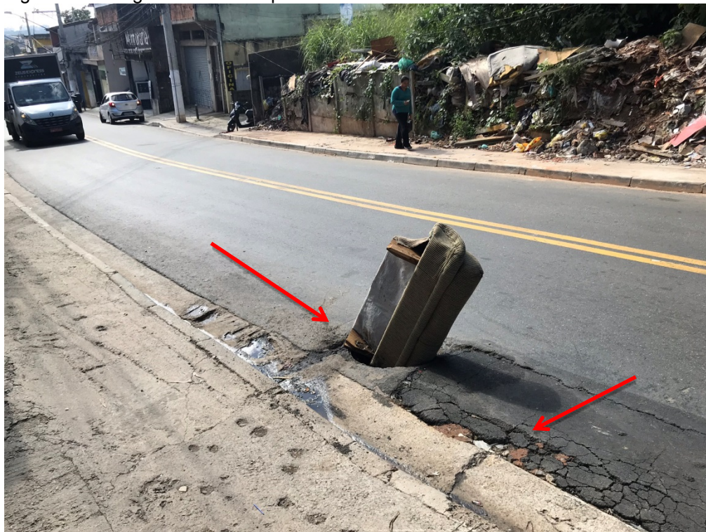
Figura 89 – Irregularidade na capa asfáltica.
