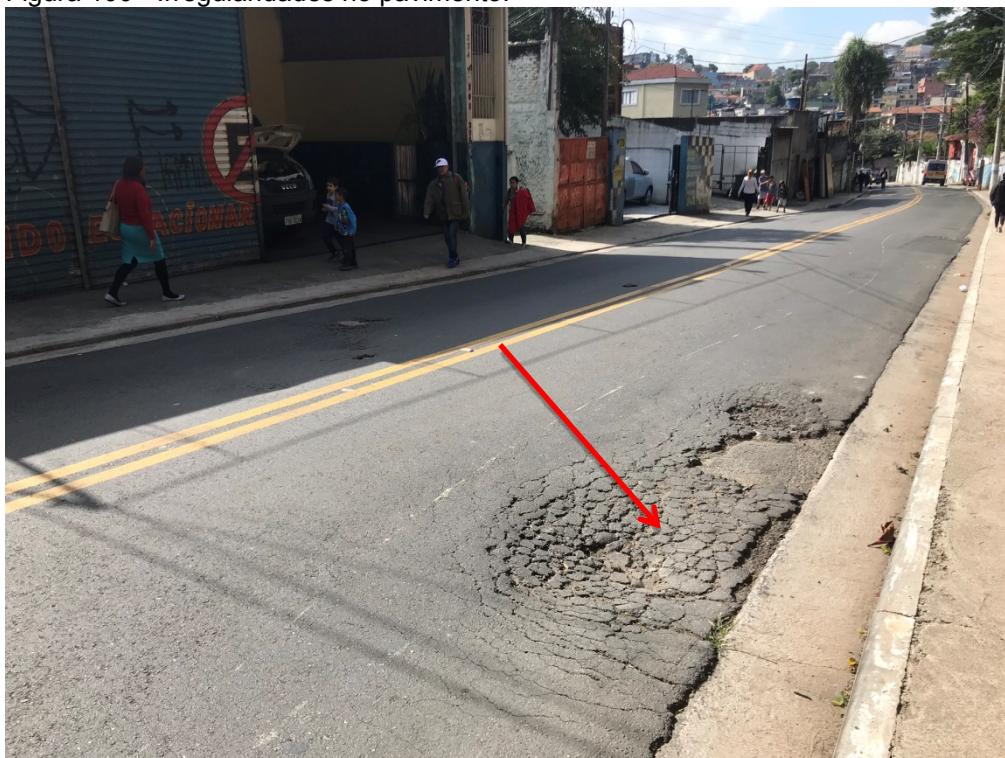
Figura 100 - Irregularidades no pavimento.
