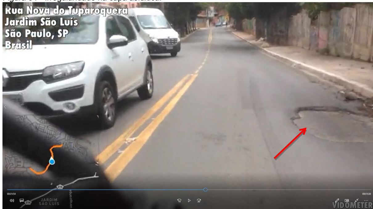
Figura 54 - Irregularidade na capa asfáltica.
