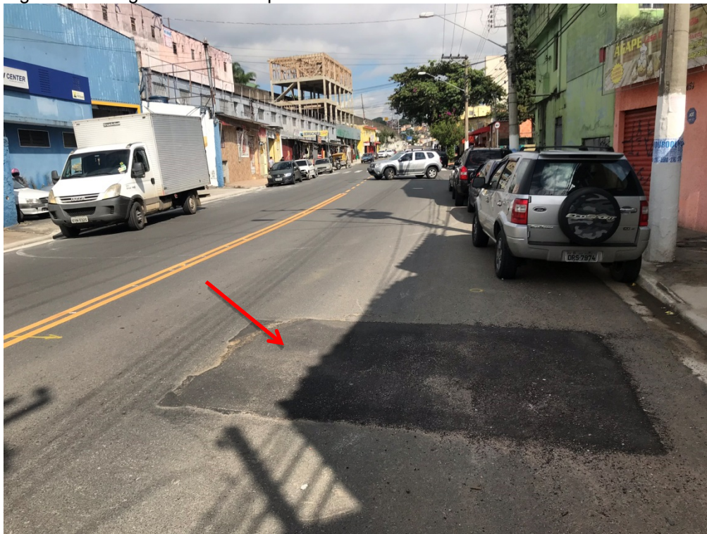
Figura 75 - Irregularidade na capa asfáltica.
