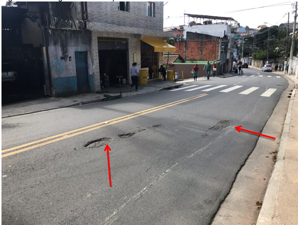
Figura 105 - Irregularidades no pavimento.
