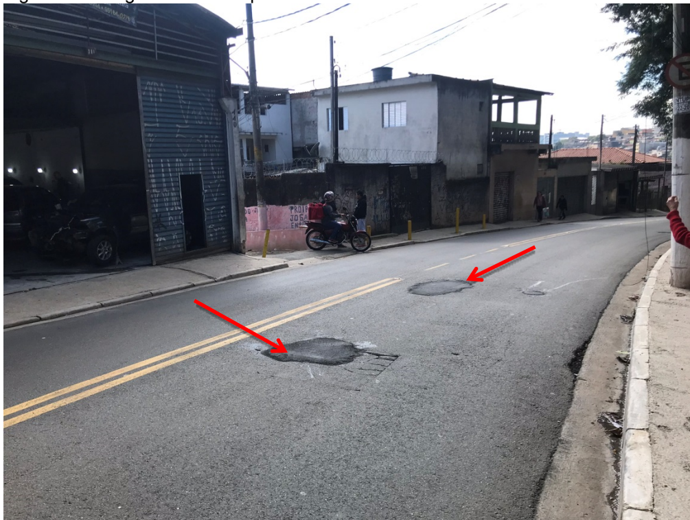
Figura 93 - Irregularidades no pavimento.
