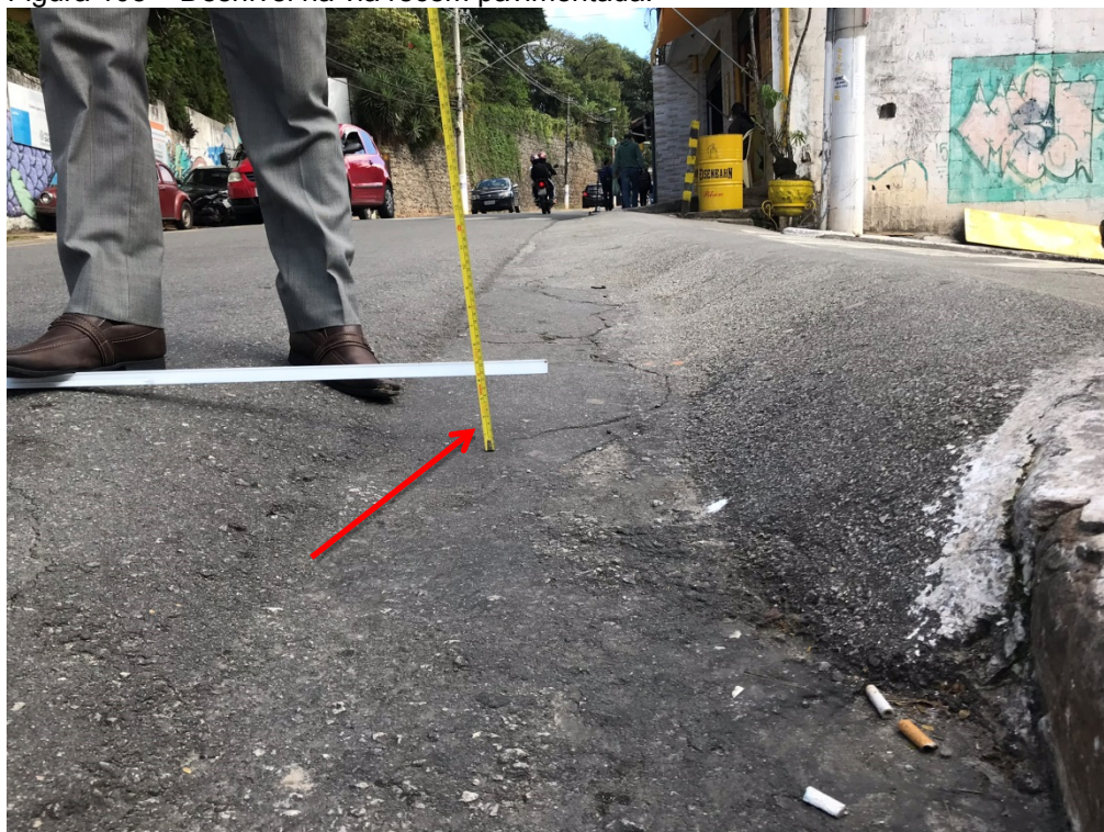
Figura 108 – Desnível na via recém pavimentada.
