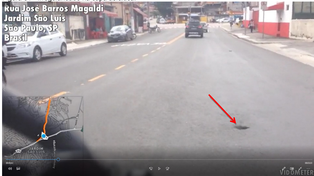
Figura 51 - Irregularidade na capa asfáltica.
