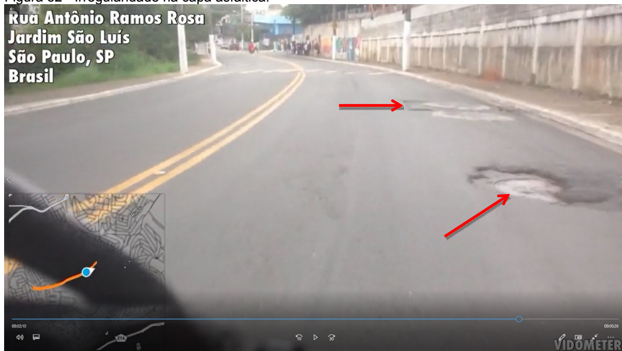
Figura 52 - Irregularidade na capa asfáltica.
