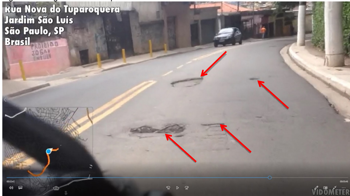
Figura 53 - Irregularidade na capa asfáltica.
