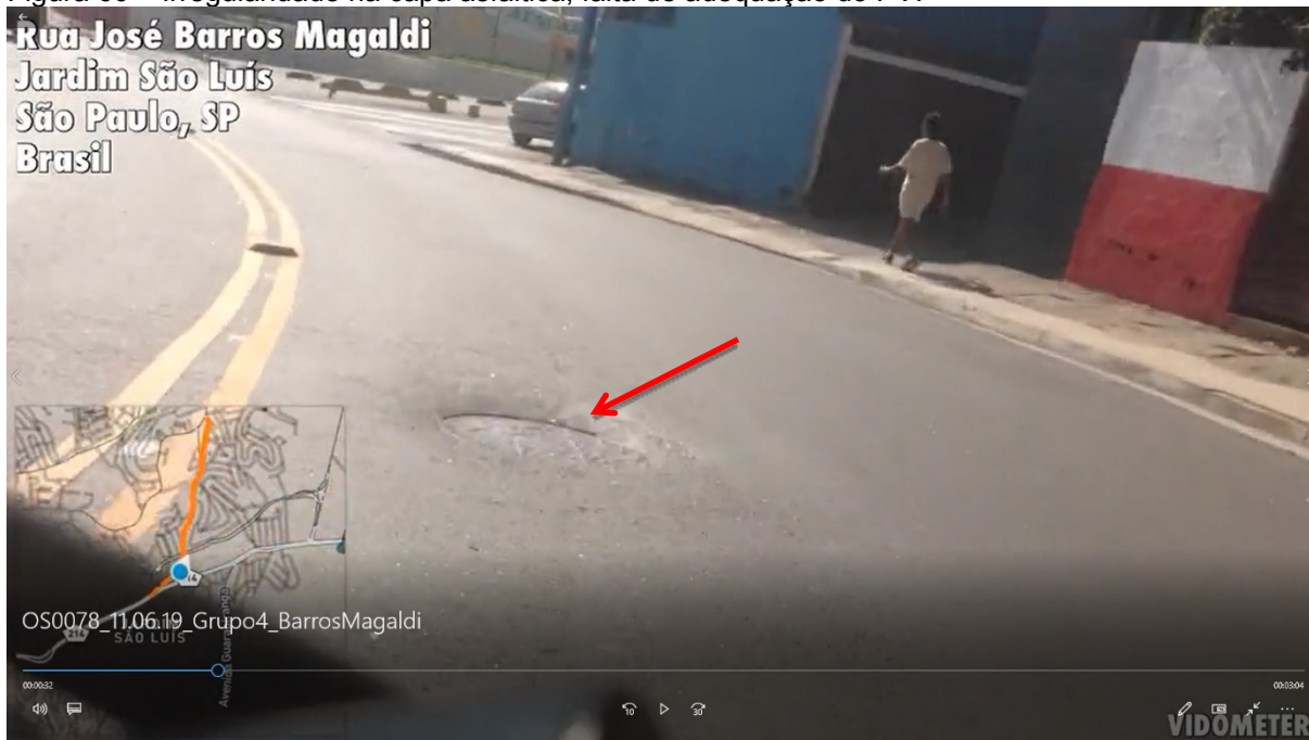
Figura 60 – Irregularidade na capa asfáltica; falta de adequação do PV.
