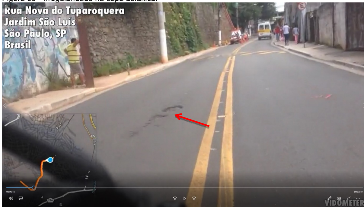
Figura 59 - Irregularidade na capa asfáltica.
