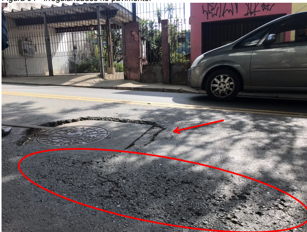
Figura 94 - Irregularidades no pavimento.
