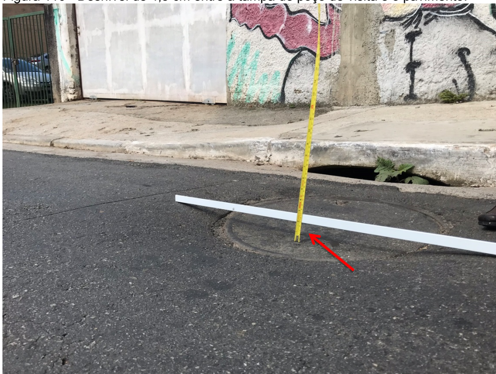
Figura 110 - Desnível de 4,5 cm entre a tampa de poço de visita e o pavimento.
