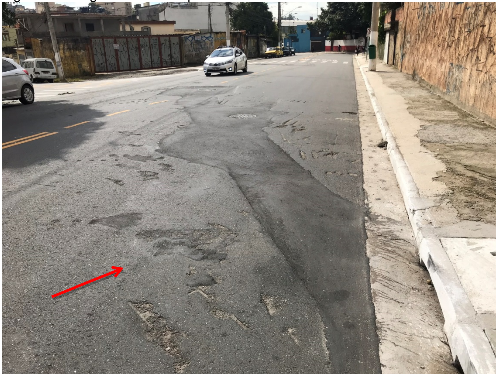
Figura 71 - Irregularidade na capa asfáltica.
