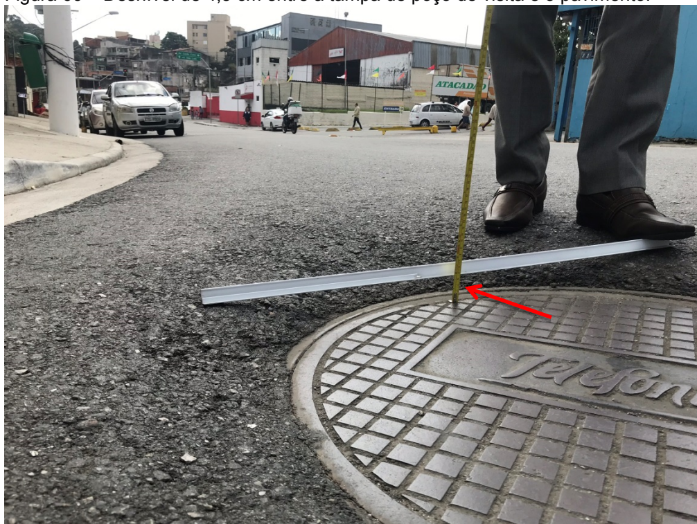
Figura 66 – Desnível de 4,5 cm entre a tampa de poço de visita e o pavimento.
