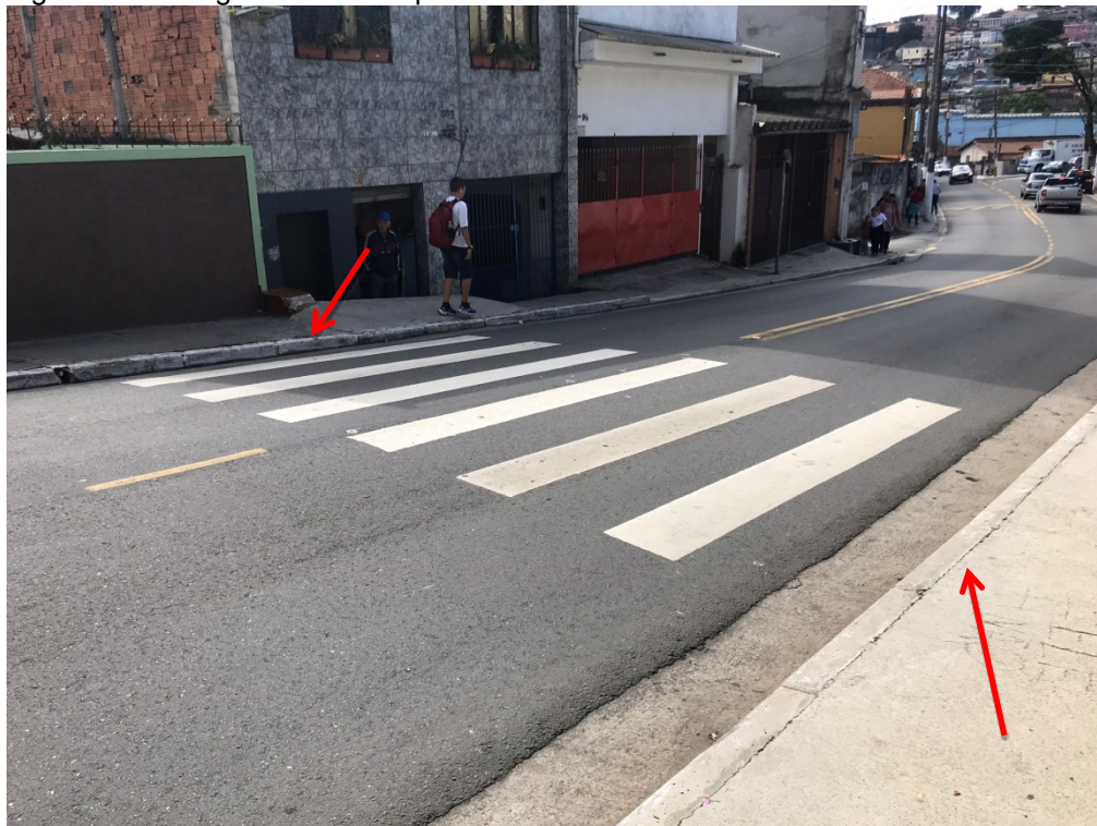
Figura 107 - Irregularidades no pavimento.
