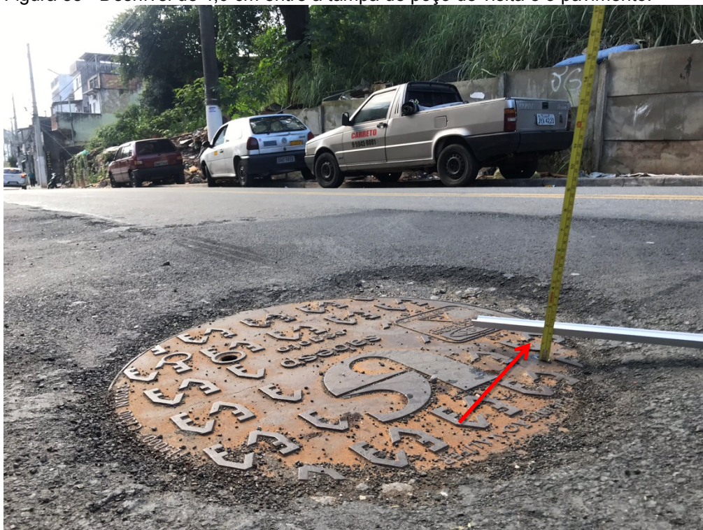
Figura 88 - Desnível de 4,0 cm entre a tampa de poço de visita e o pavimento.
