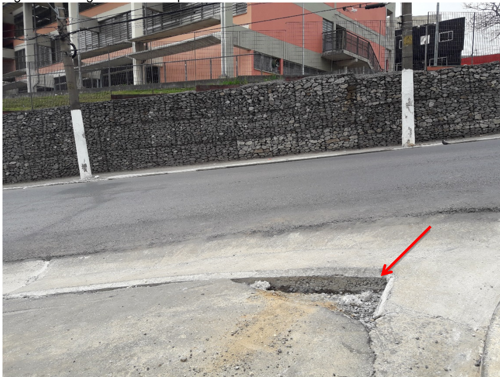
Figura 3 – Irregularidades no pavimento.
