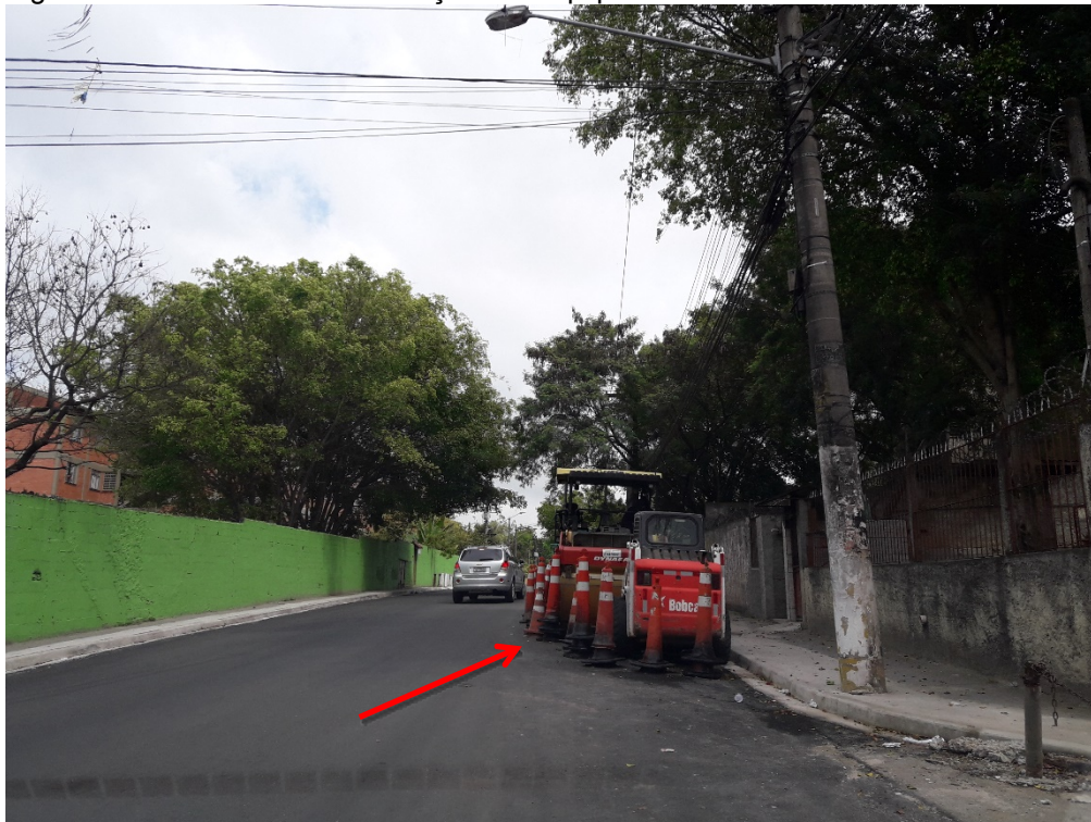
Figura 21 – Isolamento e sinalização dos equipamentos.
