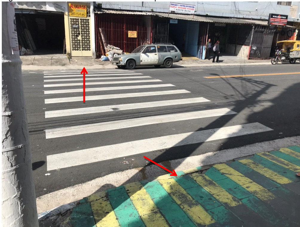
Figura 77 - Ausência de rebaixamento dos passeios nas travessias sinalizadas.
