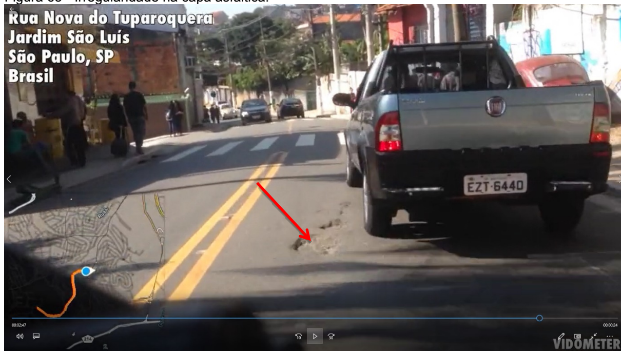
Figura 63 - Irregularidade na capa asfáltica.
