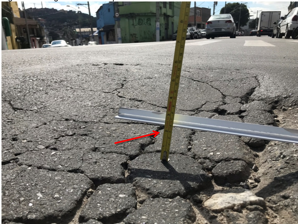
Figura 79 - Irregularidade na capa asfáltica.
