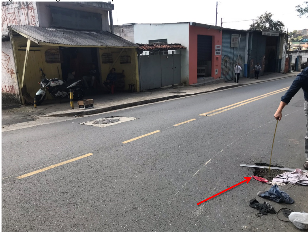
Figura 97 - Irregularidades no pavimento.
