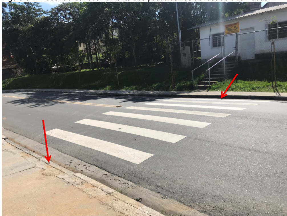
Figura 82 - Ausência de rebaixamento dos passeios nas travessias sinalizadas.
