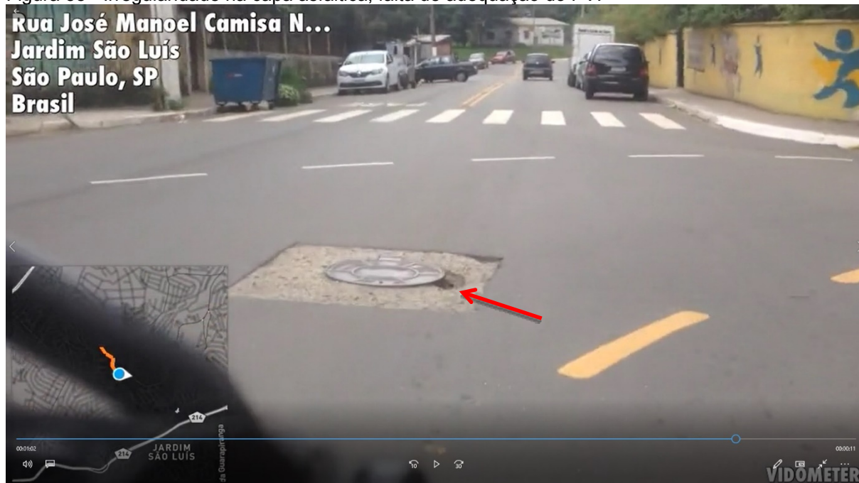
Figura 58 - Irregularidade na capa asfáltica; falta de adequação do PV.
