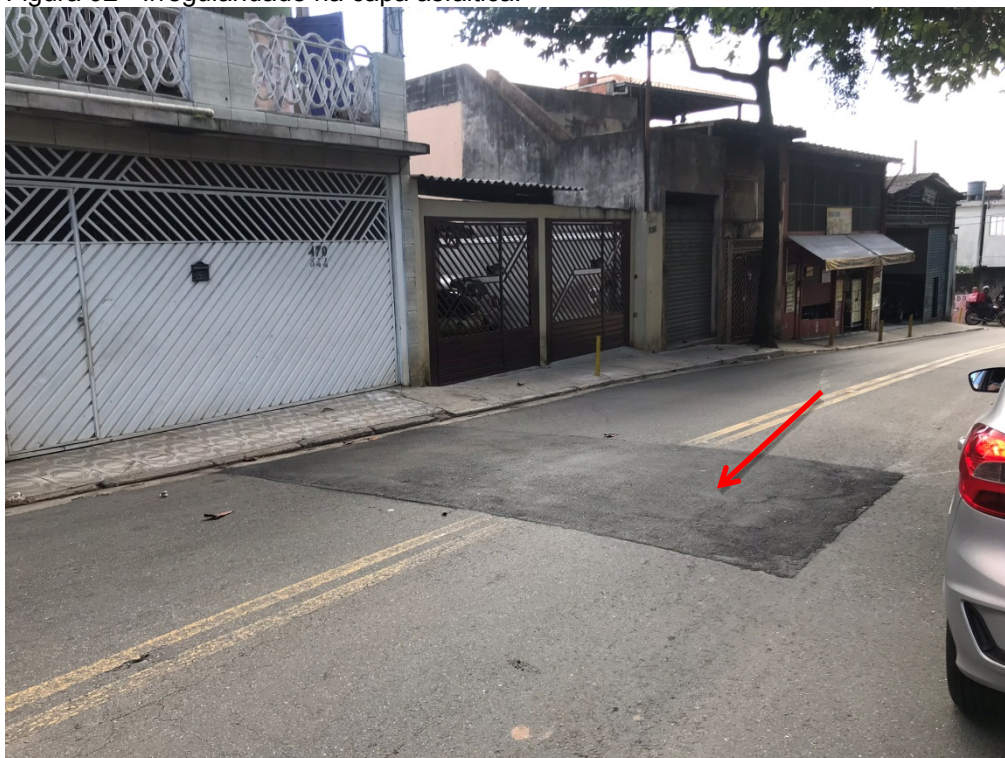
Figura 92 - Irregularidade na capa asfáltica.
