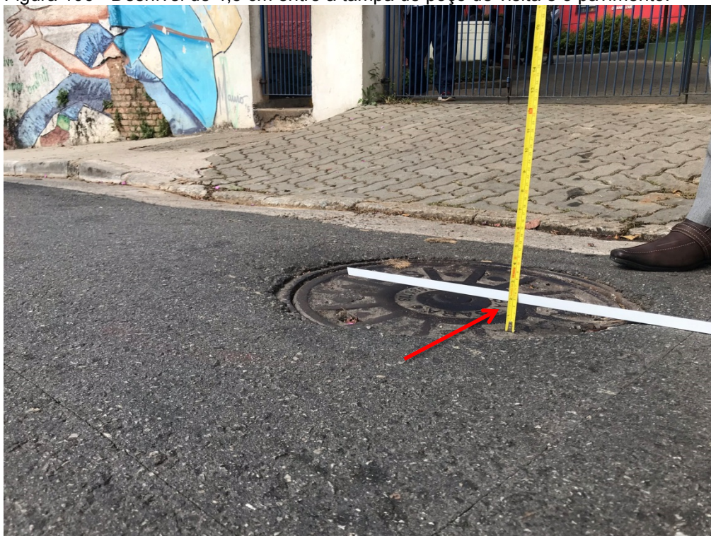
Figura 106 - Desnível de 4,5 cm entre a tampa de poço de visita e o pavimento.
