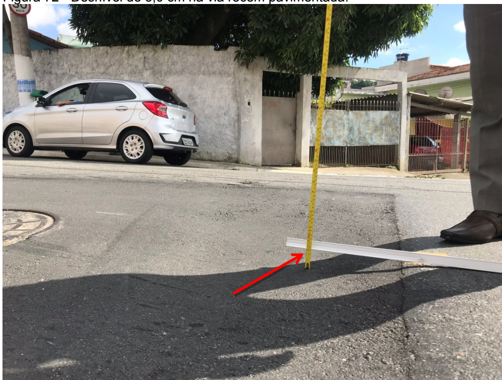
Figura 72 - Desnível de 5,0 cm na via recém pavimentada.
