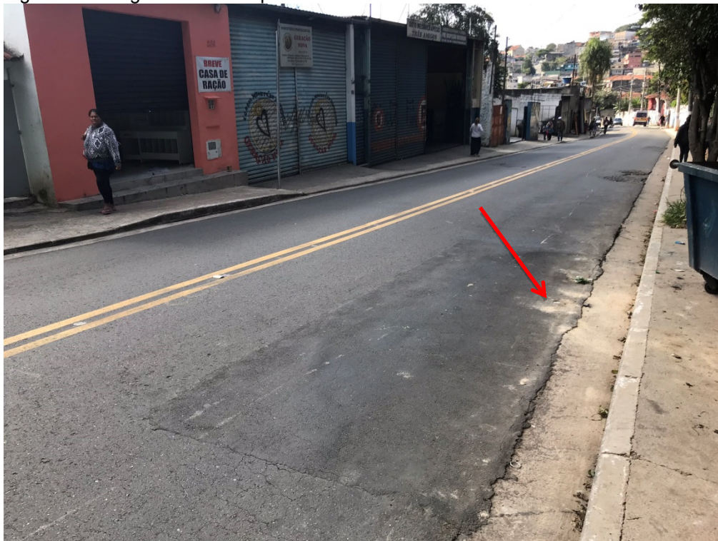
Figura 99 - Irregularidades no pavimento.
