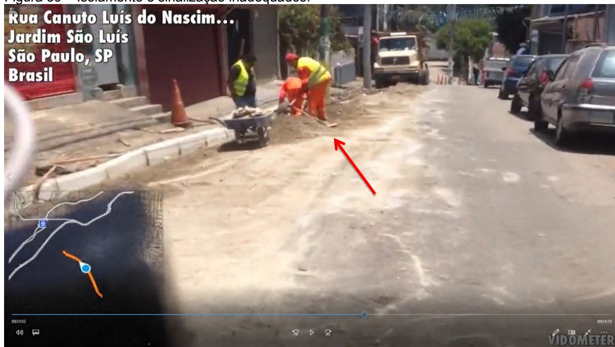
Figura 39 – Isolamento e sinalização inadequados.
