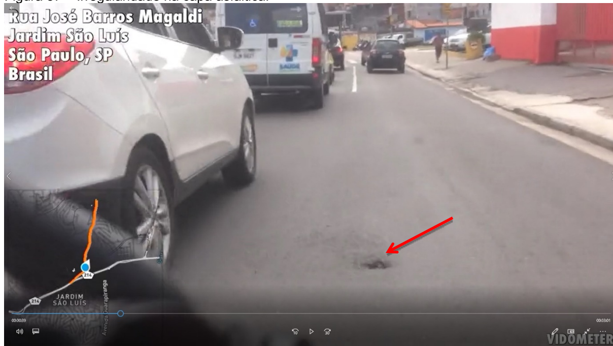
Figura 57 – Irregularidade na capa asfáltica.
