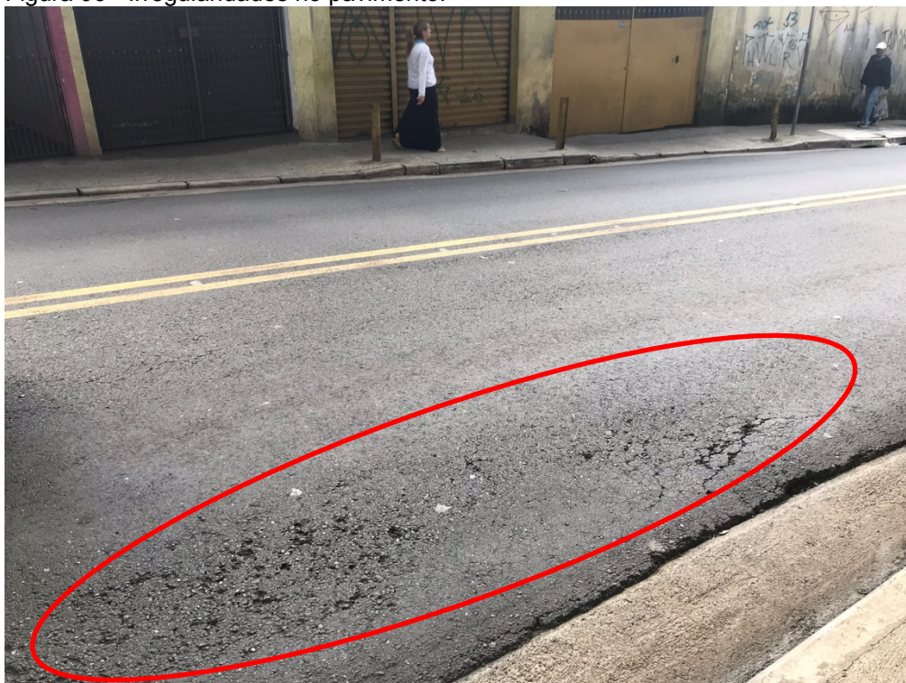
Figura 96 - Irregularidades no pavimento.
