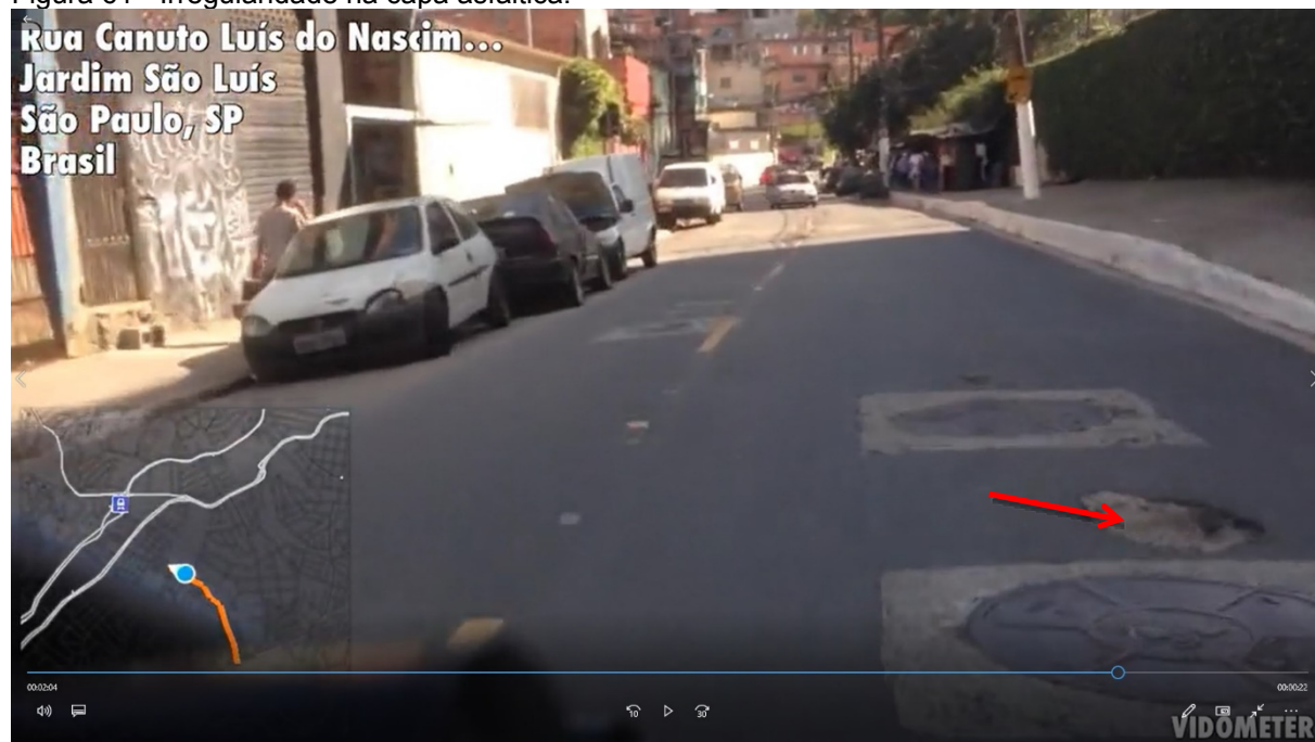
Figura 61 - Irregularidade na capa asfáltica.
