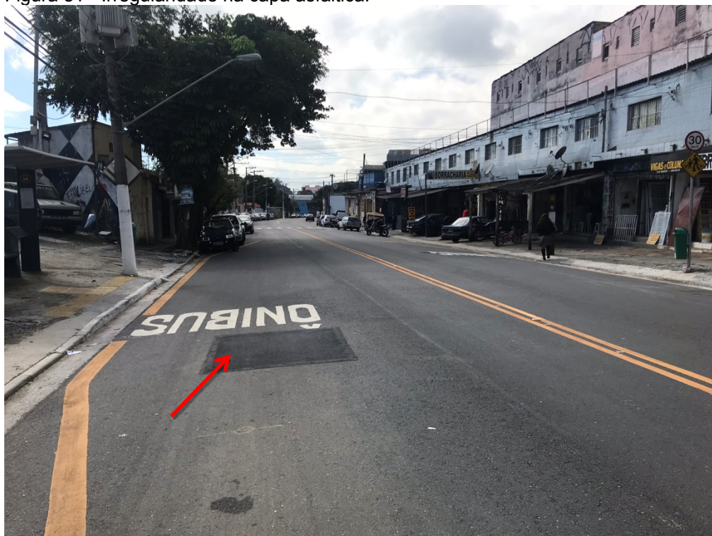
Figura 81 - Irregularidade na capa asfáltica.
