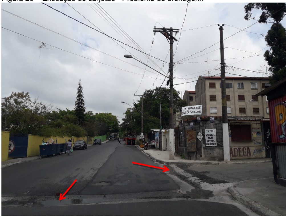
Figura 20 – Execução do sarjetão - Problema de drenagem.
