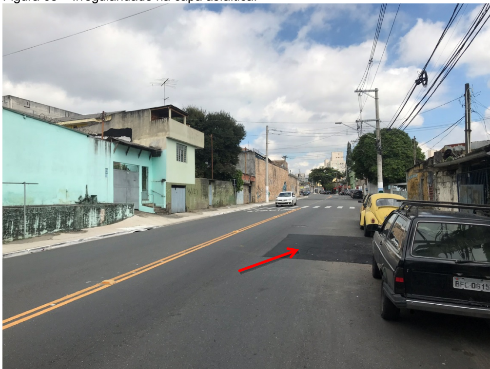
Figura 68 – Irregularidade na capa asfáltica.
