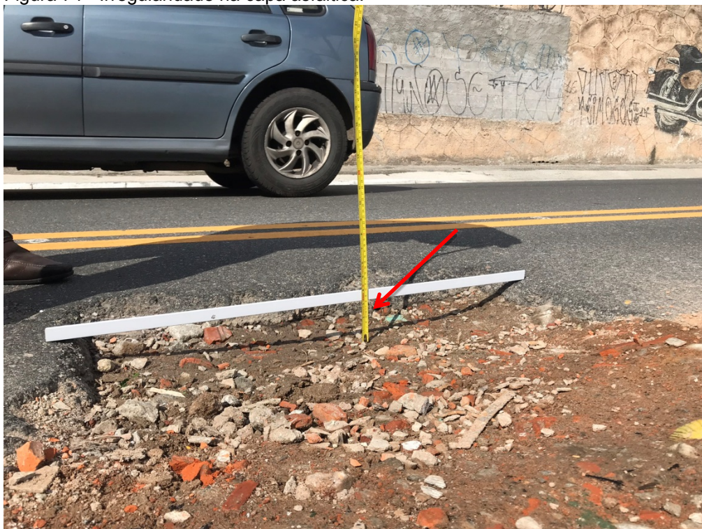
Figura 74 - Irregularidade na capa asfáltica.
