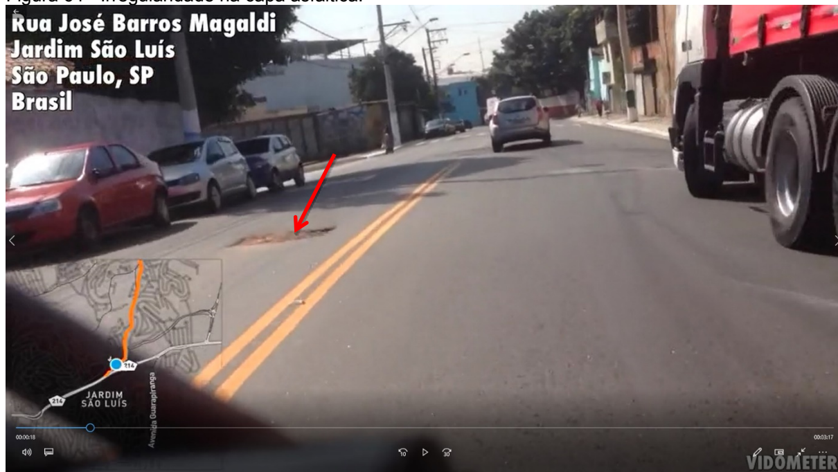
Figura 64 - Irregularidade na capa asfáltica.
