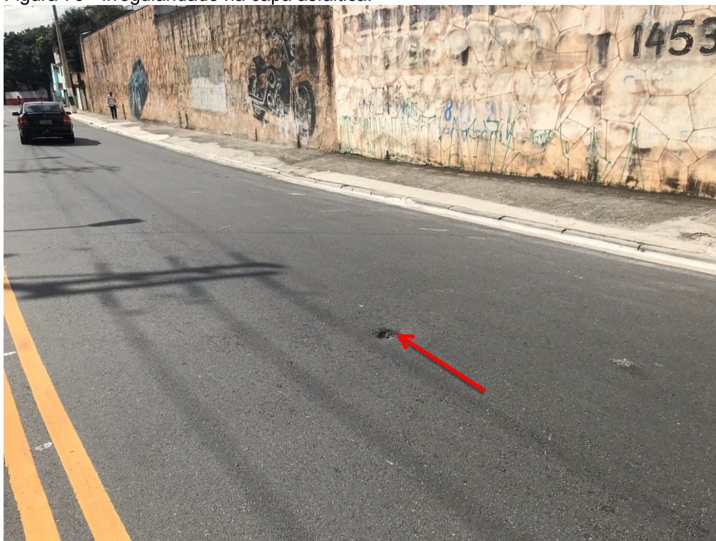
Figura 76 - Irregularidade na capa asfáltica.
