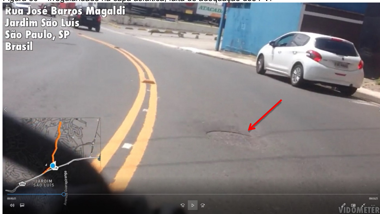
Figura 50 – Irregularidade na capa asfáltica; falta de adequação dos PV.
