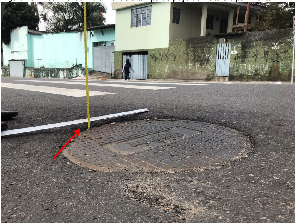
Figura 70 - Desnível de 4,0 cm entre a tampa de poço de visita e o pavimento.
