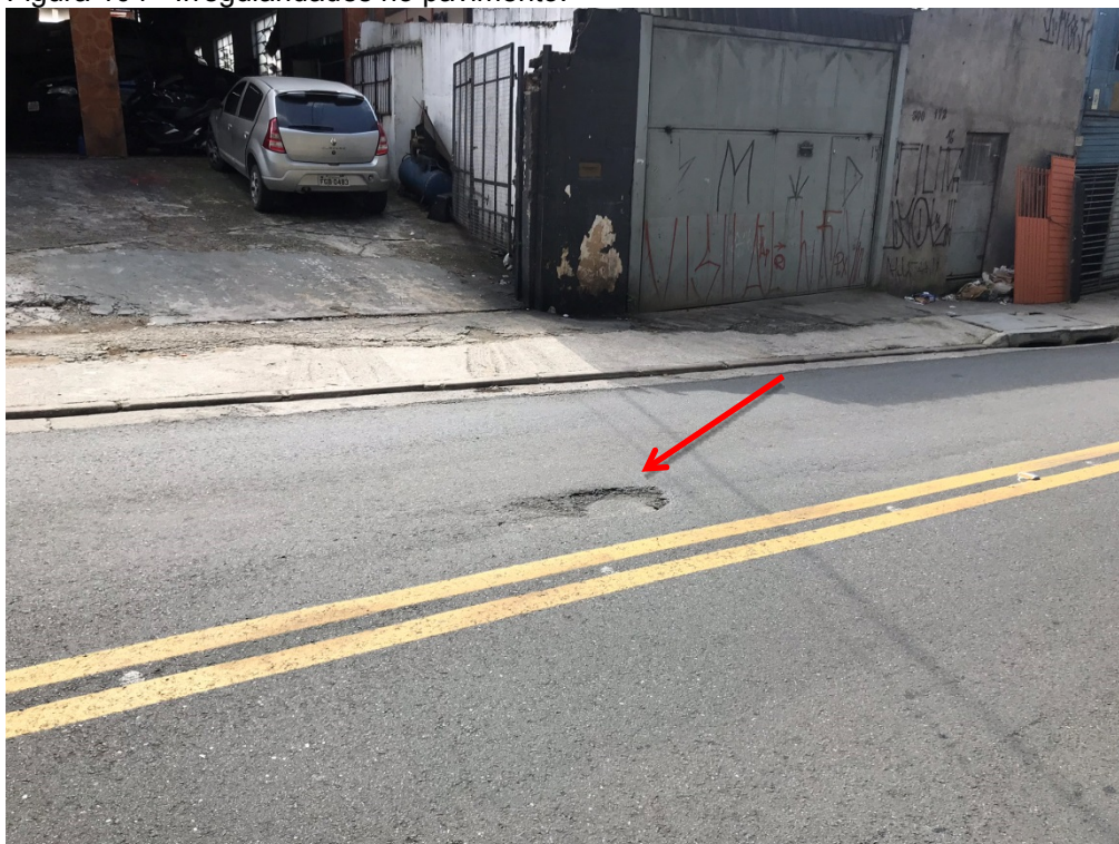
Figura 104 - Irregularidades no pavimento.
