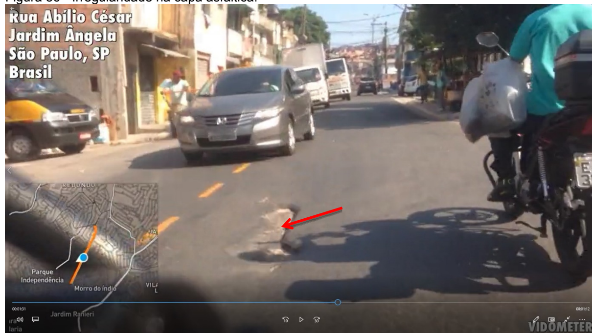
Figura 56 - Irregularidade na capa asfáltica.
