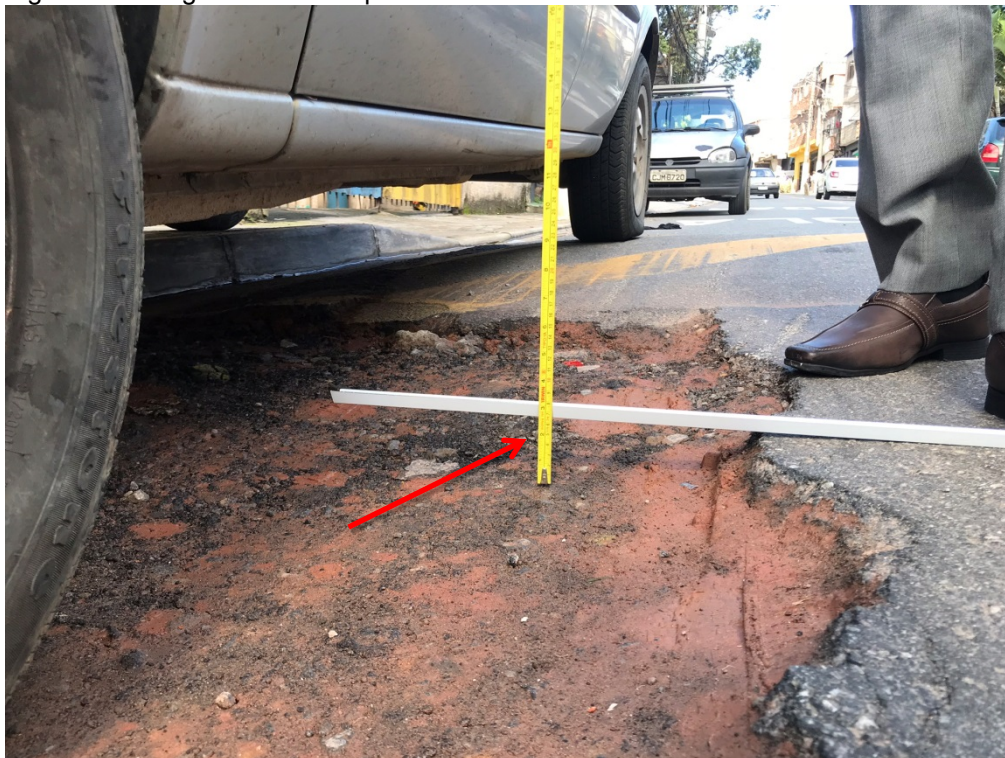
Figura 91 - Irregularidades no pavimento.
