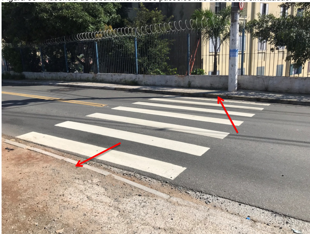
Figura 86 - Ausência de rebaixamento dos passeios nas travessias sinalizadas.
