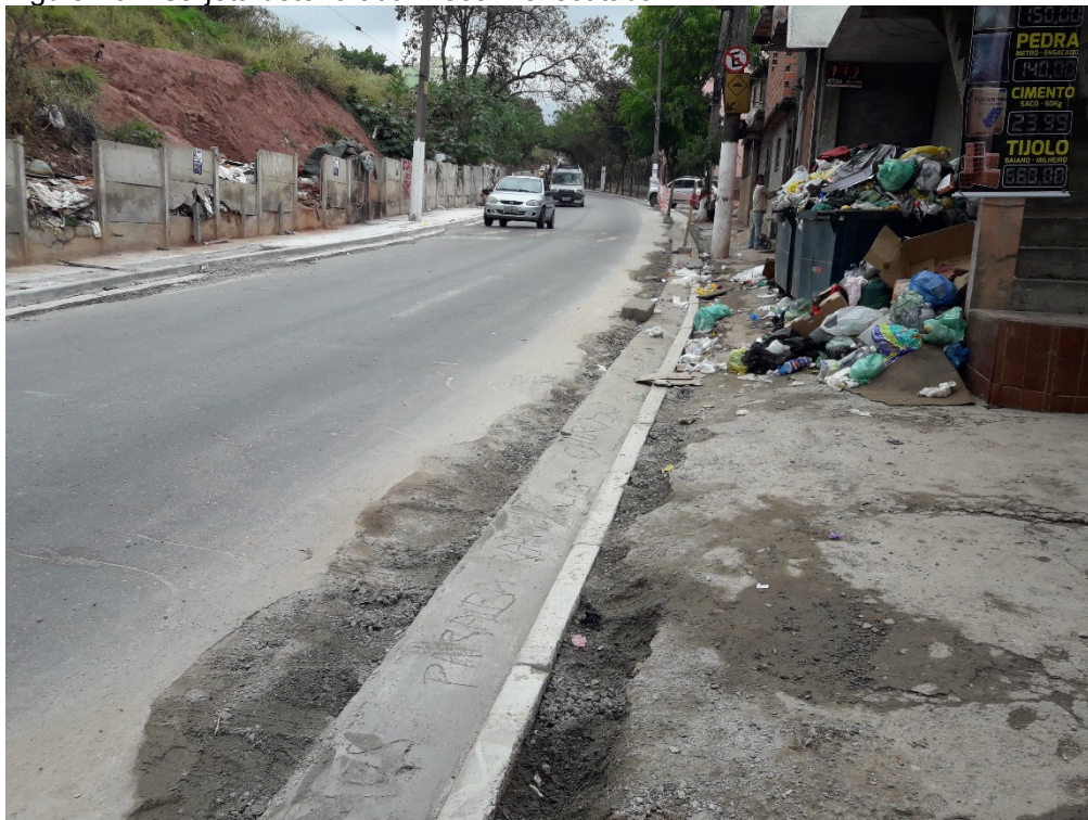
Figura 16 – Sarjeta deteriorada - recém-executada.
