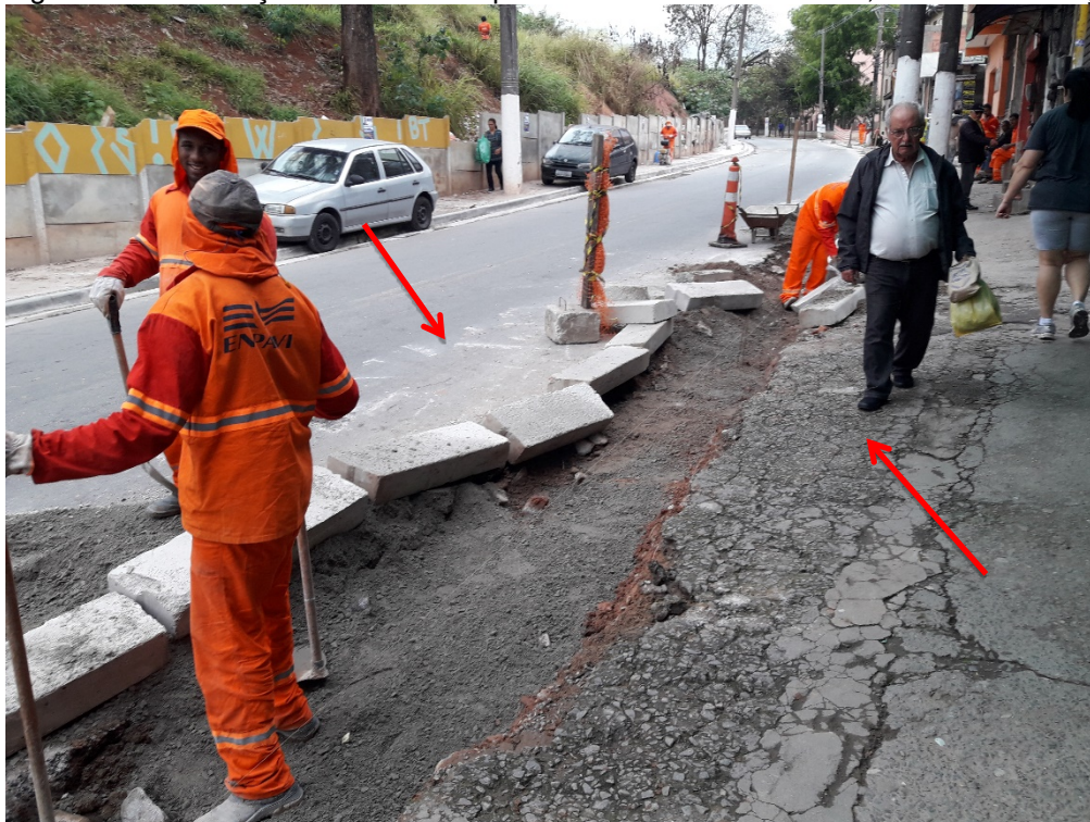
Figura 15 - Sinalização e isolamento que deveriam ser melhorados, devido a circulação de pedestres
