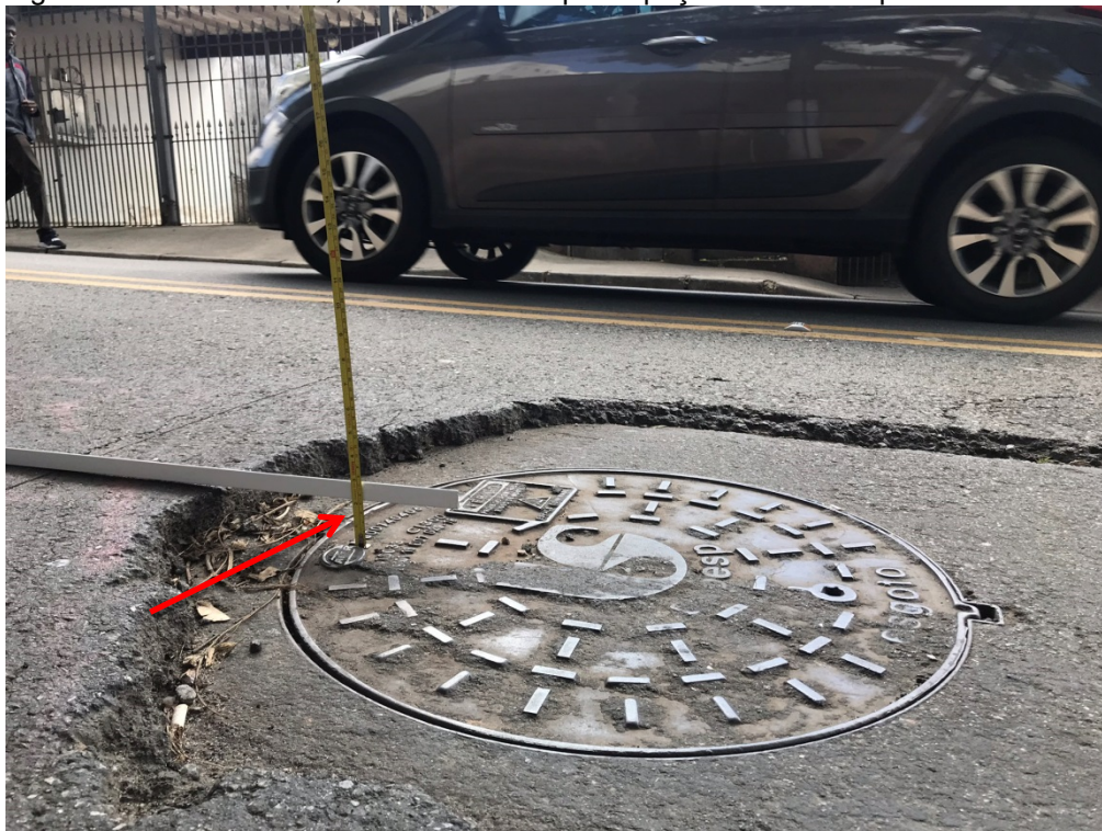
Figura 95 - Desnível de 5,0 cm entre a tampa de poço de visita e o pavimento.
