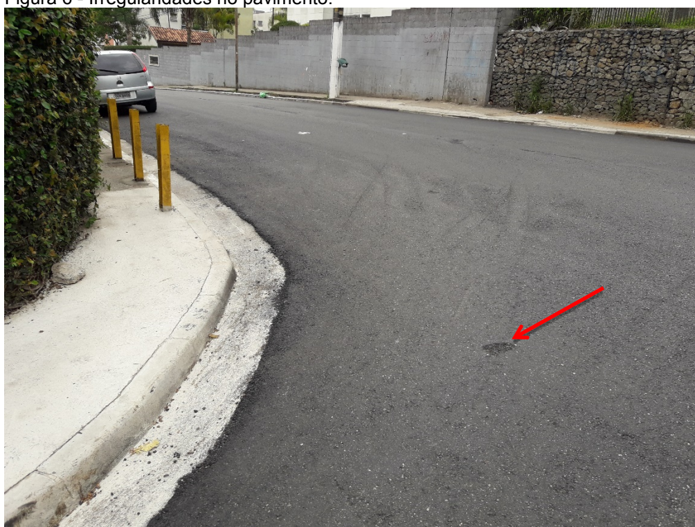
Figura 6 - Irregularidades no pavimento.
