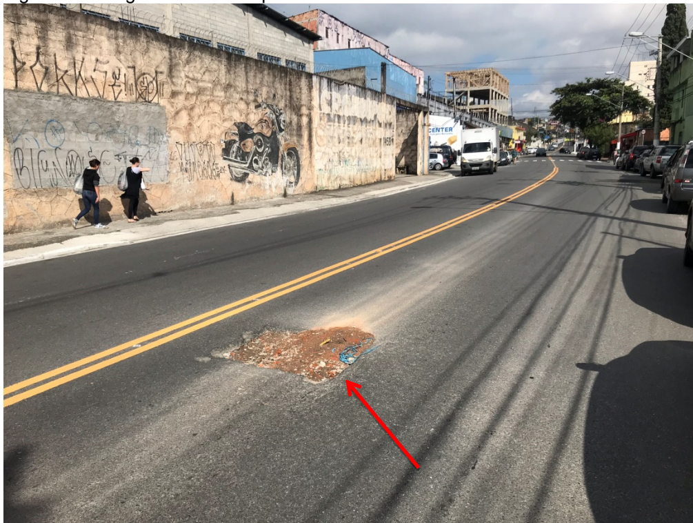
Figura 73 - Irregularidade na capa asfáltica.
