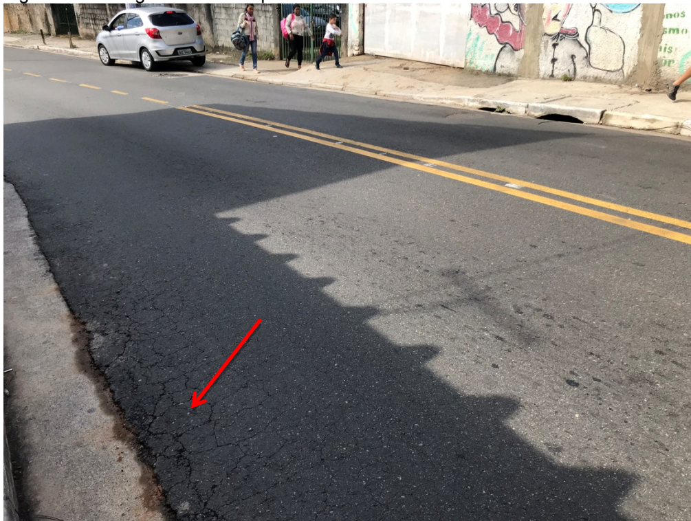
Figura 109 - Irregularidades no pavimento.
