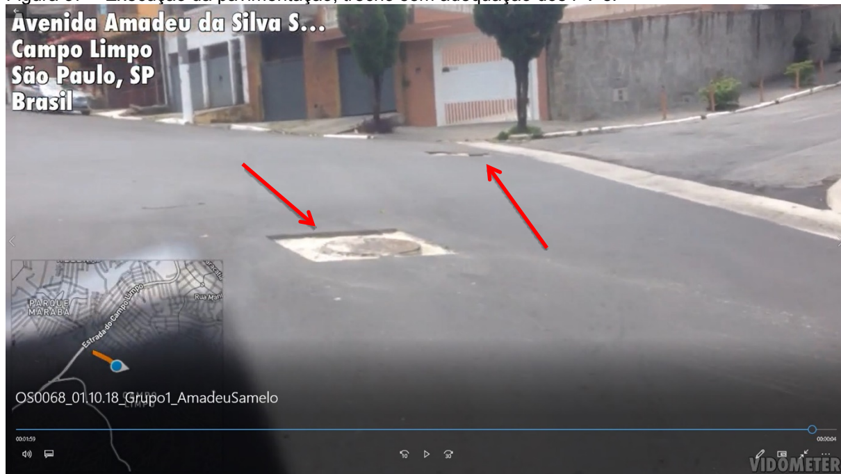
Figura 37 – Execução da pavimentação; trecho sem adequação dos PV's.
