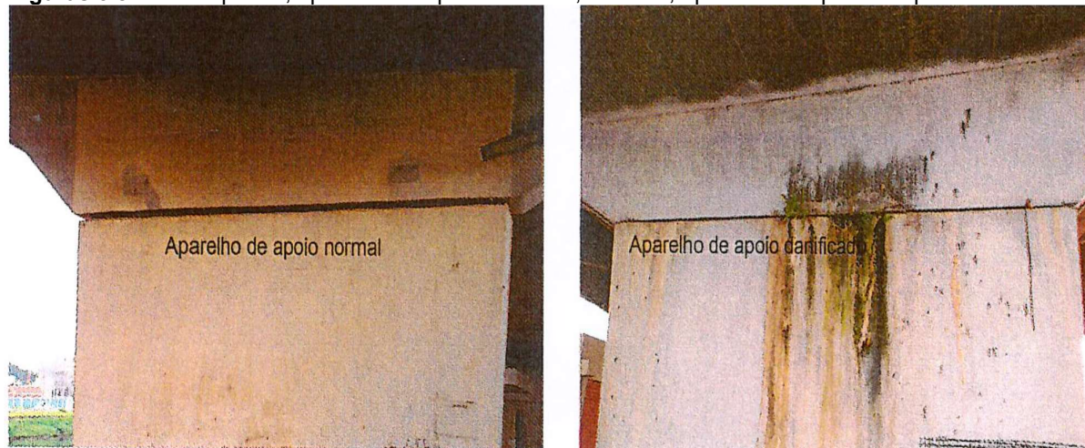
Figuras 3 e 4 - À esquerda, aparelho de apoio normal e, à direita, aparelho de apoio comprometido.
