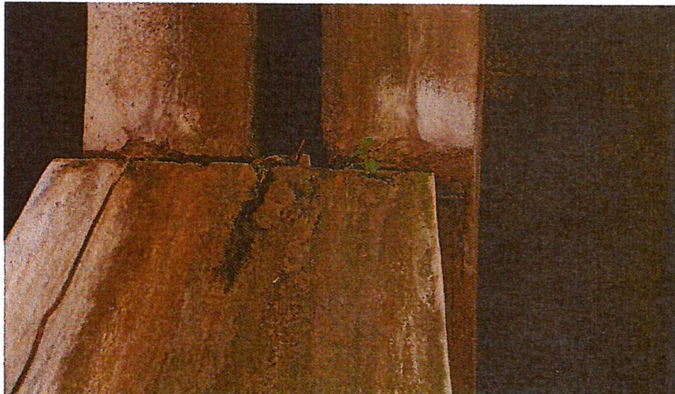
Figura 1 - Grande abertura da junta de dilatação, com o consequente deslocamento da viga com trecho sem apoio sobre o pilar.
