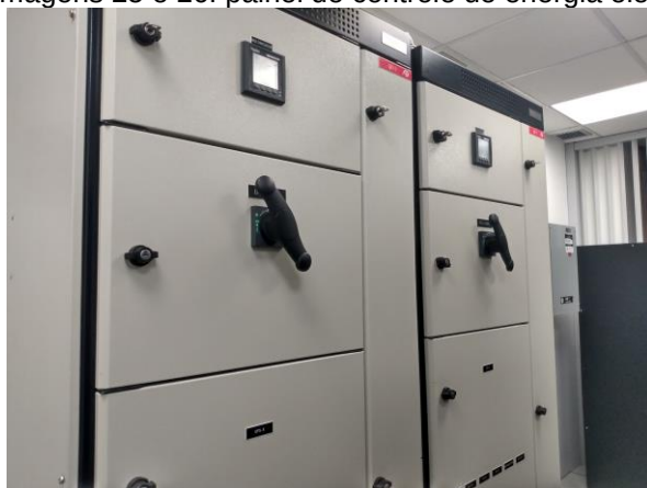
Imagens 25 e 26: painel de controle de energia elétrica
