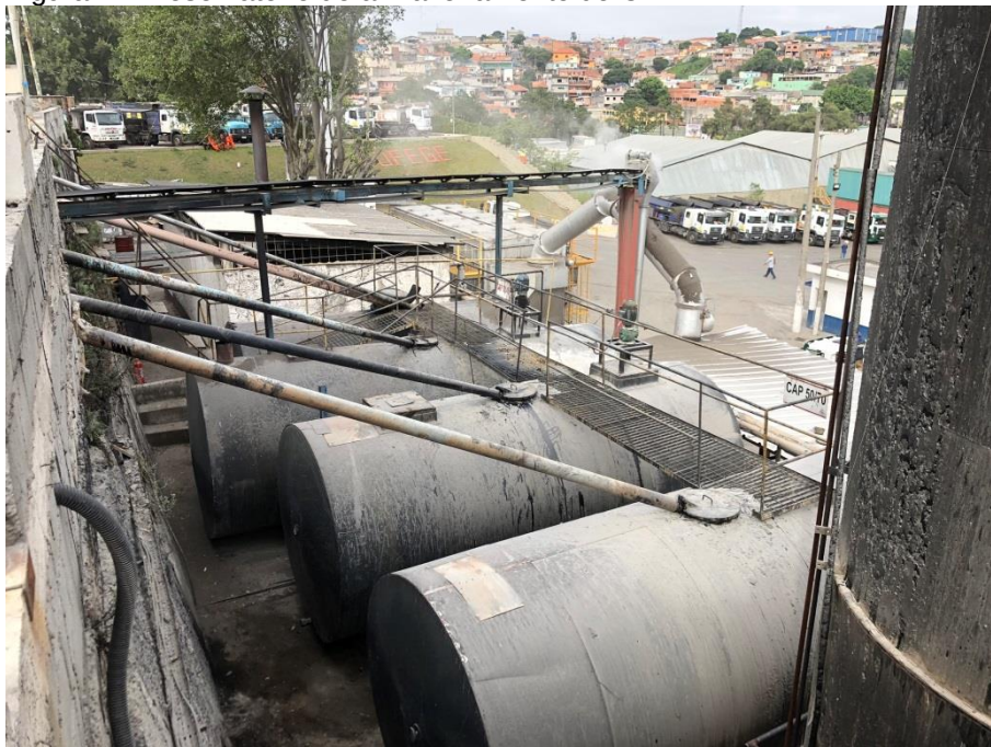
Figura 2 – Reservatório de armazenamento do CAP
