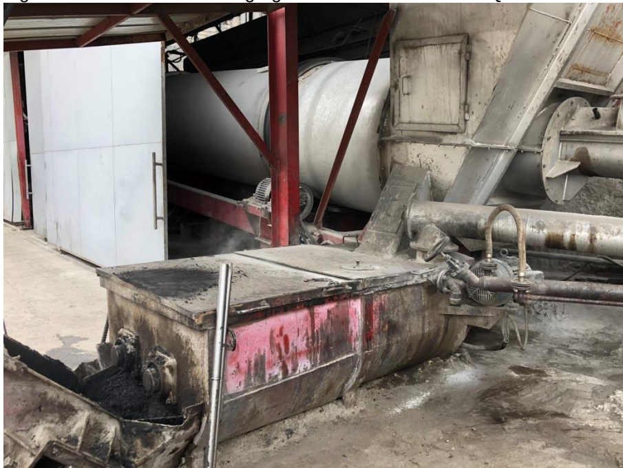
Figura 1 – Tubo secador de agregado e misturador de CBUQ
