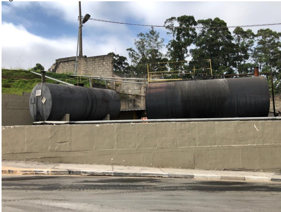
Figura 4 – Reservatório de armazenamento da emulsão asfáltica
