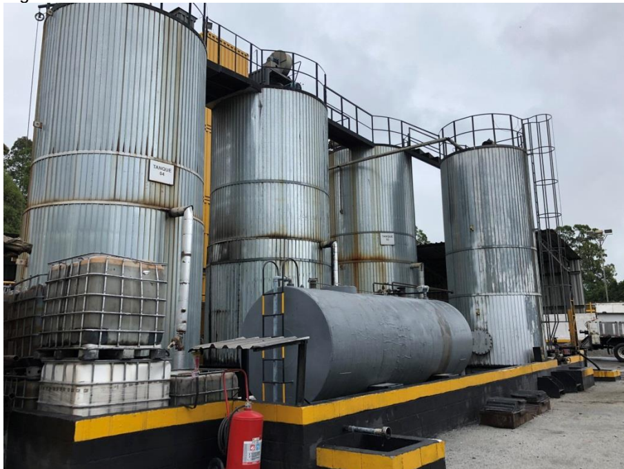
Figura 2 – Reservatório de armazenamento do CAP
