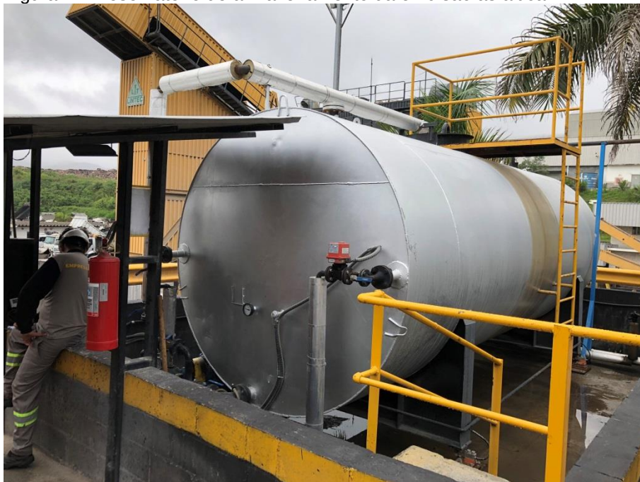
Figura 4 – Reservatório de armazenamento da emulsão asfáltica
