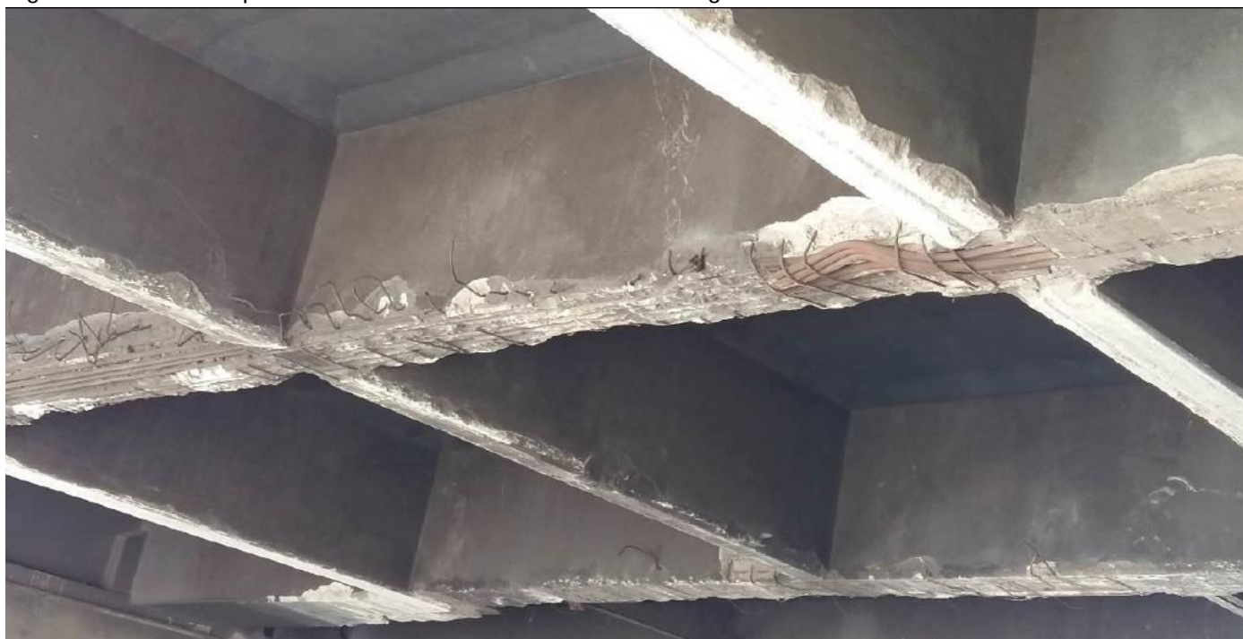
Figura 2 – Detalhe da perda da camada inferior de armadura da viga central do 2º vão sentido norte.
