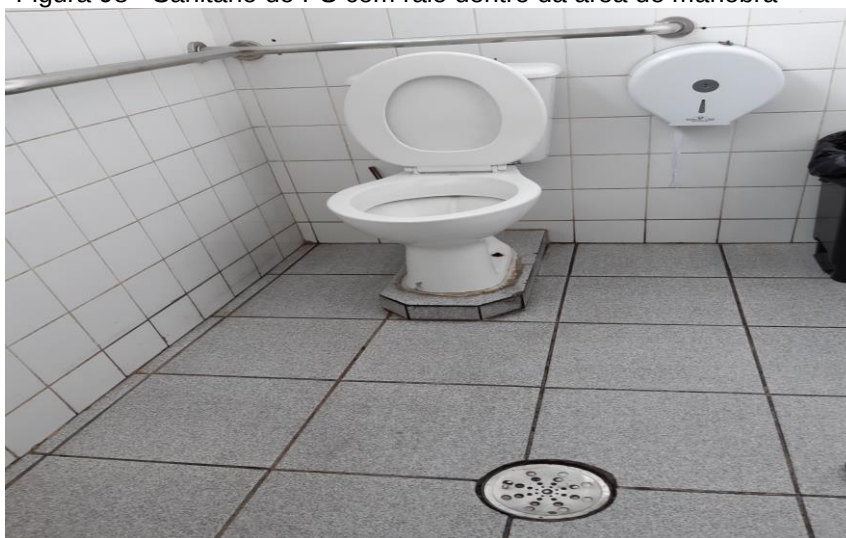
Figura 98 - Sanitário do PS com ralo dentro da área de manobra
