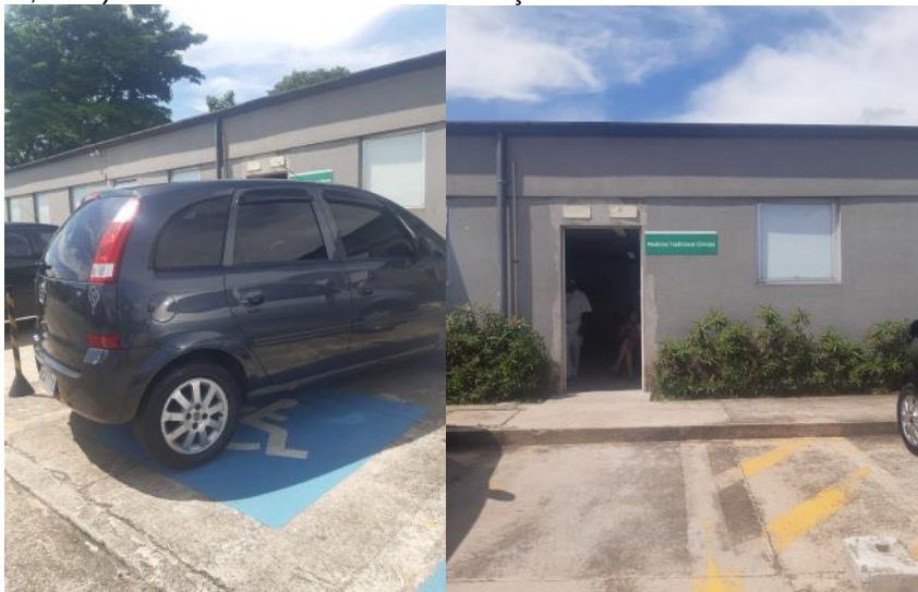
Figura 76 - Vaga acessível com dimensões inadequadas (4,17 m x 2,38 m) e obstáculo na faixa de circulação
