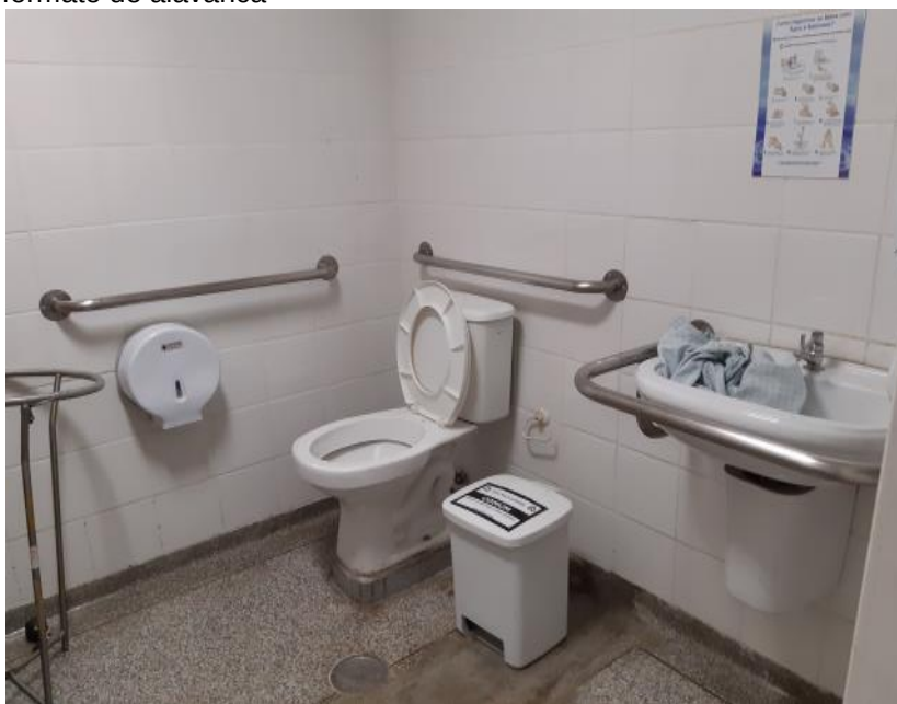
Figura 73 - Sanitário da enfermaria com barras de apoio e torneira em formato de alavanca
