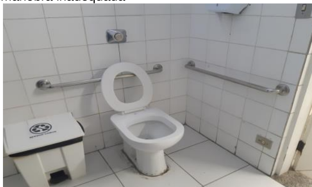
Figura 20 - Sanitário de uso comum com área de manobra inadequada
