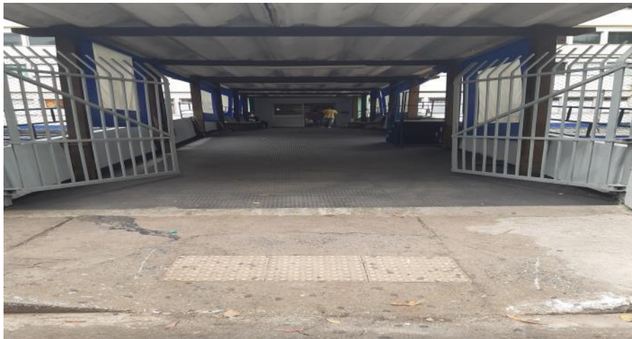
Figura 82 - Entrada de visitantes com piso de alerta no início da rampa, mas sem corrimão
