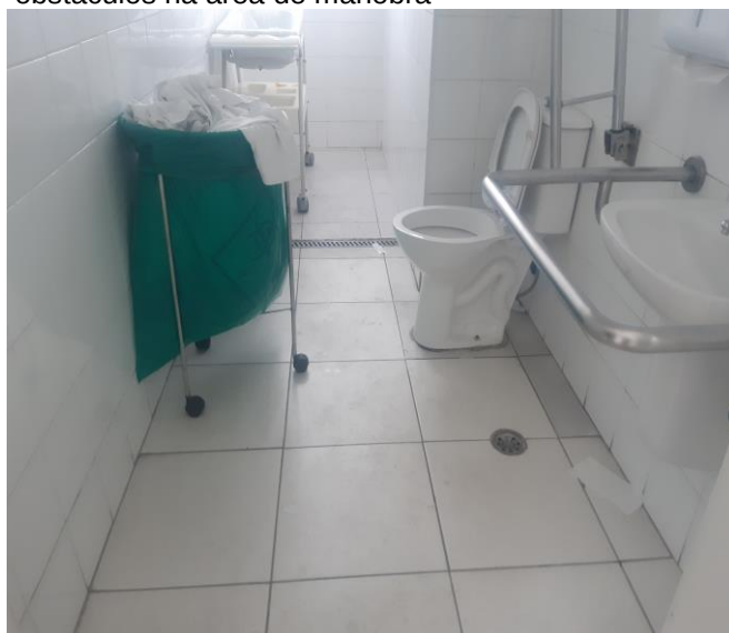
Figura 49 - Ausência de barras adequadas e obstáculos na área de manobra
