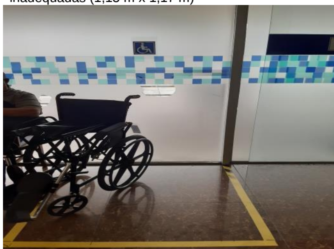
Figura 40 - Espaço reservado para deficientes na área de espera da recepção de visitantes com dimensões inadequadas (1,15 m x 1,17 m)
