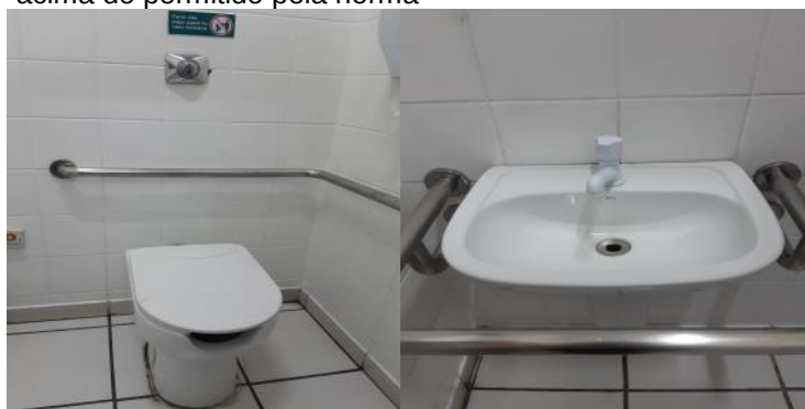
Figura 59 - Sanitário da recepção de visitas com abertura frontal, torneira de rosca e altura da válvula de descarga acima do permitido pela norma
