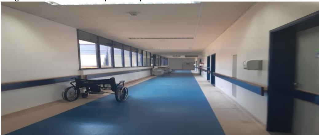
Figura 3 - Corredor do hospital sem piso tátil
