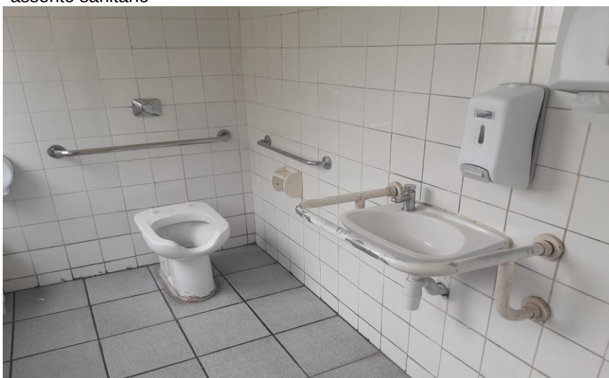
Figura 85 - Sanitário acessível do ambulatório com abertura frontal e sem assento sanitário
