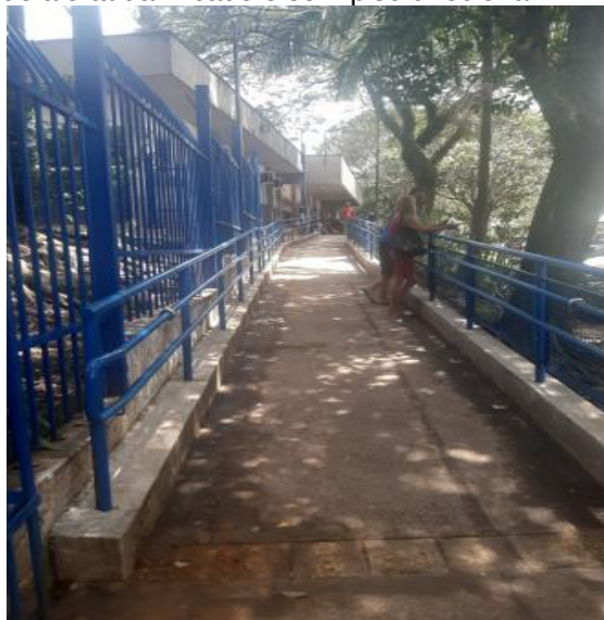
Figura 18 - Rampa de acesso ao PS com piso de alerta danificado e sem piso direcional
