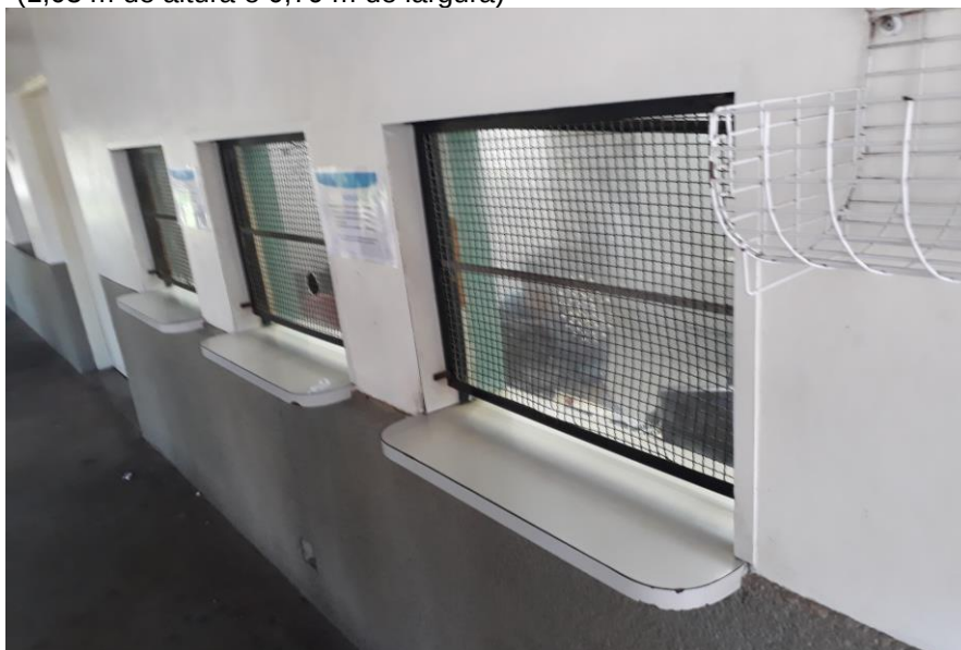
Figura 89 - Balcão de atendimento do PS com dimensões inadequadas (1,03 m de altura e 0,79 m de largura)
