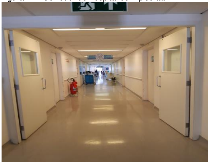
Figura 42 - Corredor do hospital sem piso tátil
