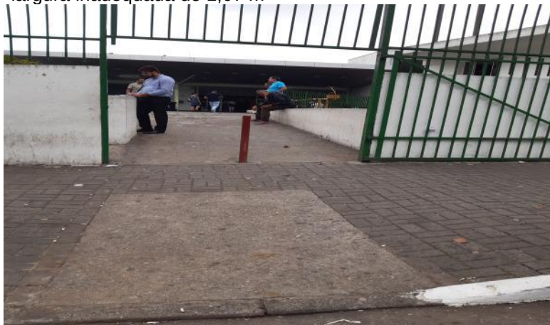
Figura 14 - Entrada com obstáculo para o Pronto Socorro – largura inadequada de 1,07 m
