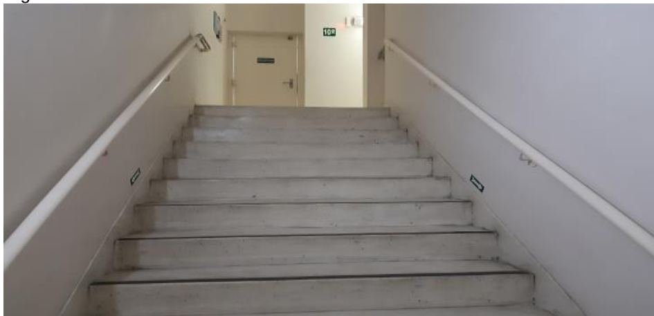
Figura 68 - Escada sem corrimão de duas alturas
