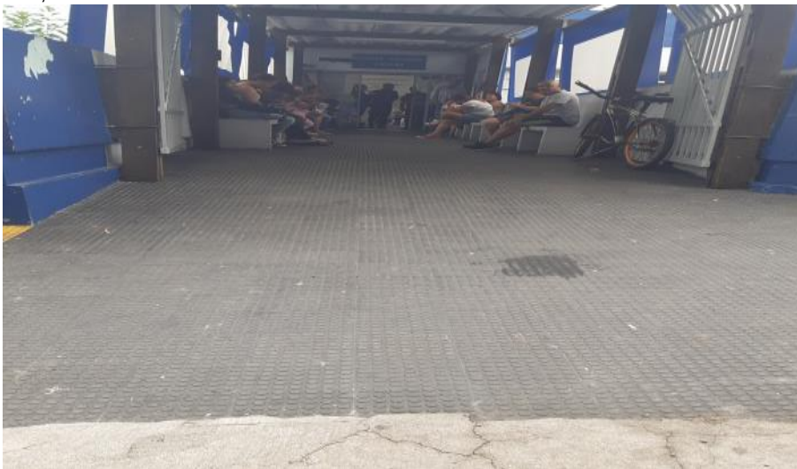
Figura 83 - A rampa do PS possui piso antiderrapante, porém não possui piso tátil, nem corrimão
