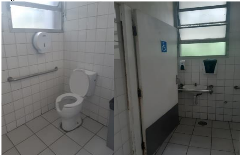
Figura 53 - Sanitário do PS com abertura frontal e torneira de rosca
