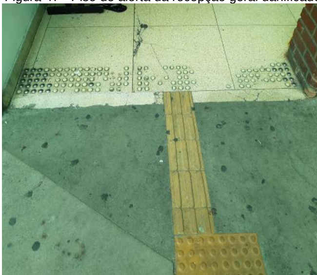
Figura 47 - Piso de alerta da recepção geral danificado
