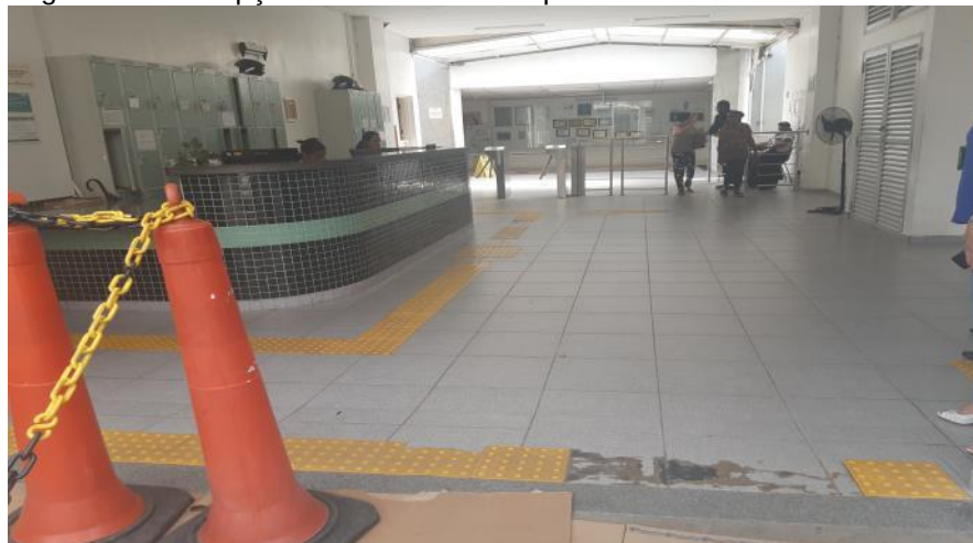
Figura 72 - Recepção de visitantes com piso de alerta danificado
