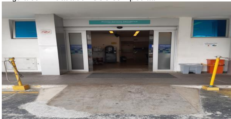
Figura 38 - Entrada do PSGO sem piso tátil
