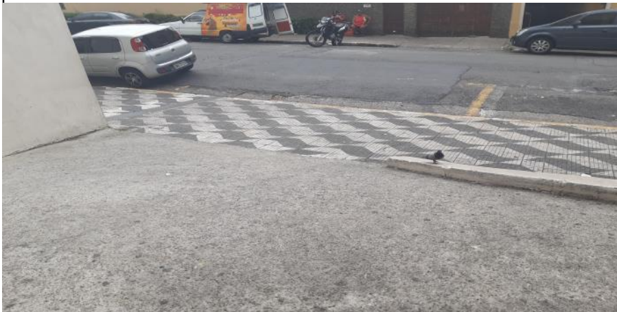
Figura 70 - Rampa de acesso ao PS com inclinação acentuada, mas sem piso tátil e sem corrimão
