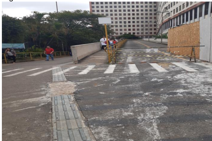
Figura 106 - Piso direcional danificado
