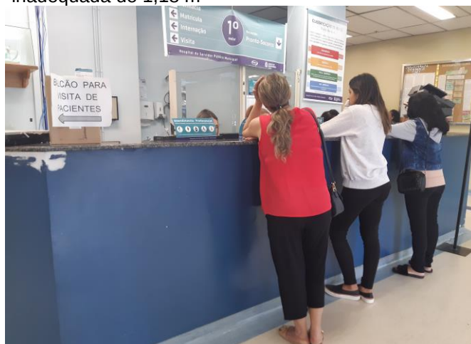
Figura 107 - Balcão da recepção principal com altura inadequada de 1,18 m
