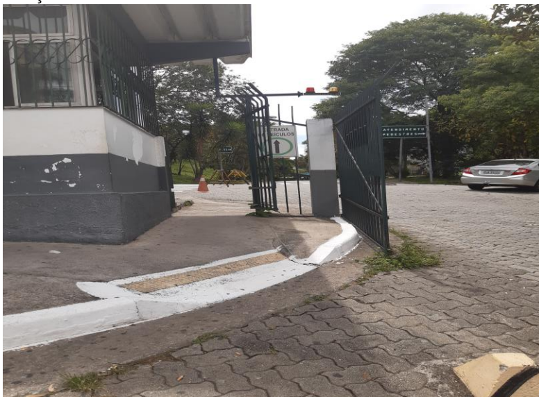
Figura 51 - Existência de piso de alerta somente da rua para calçada.
