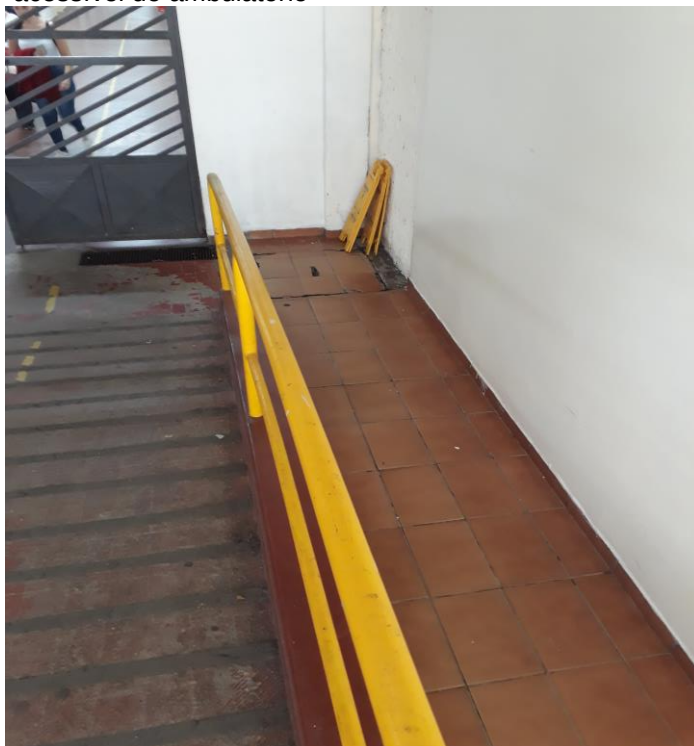
Figura 92 - Rampa inadequada para acesso ao banheiro acessível do ambulatório
