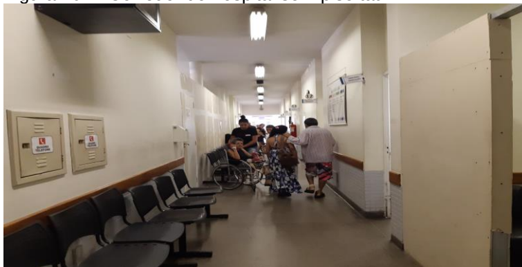
Figura 101 - Corredor do hospital sem piso tátil
