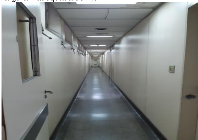
Figura 25 - Corredor de uma ala da pediatria com largura inadequada de 1,07 m
