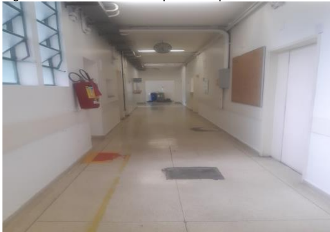
Figura 48 - Corredor do hospital sem piso tátil
