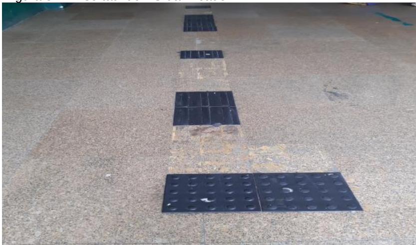
Figura 57 - Piso tátil do PS danificado
