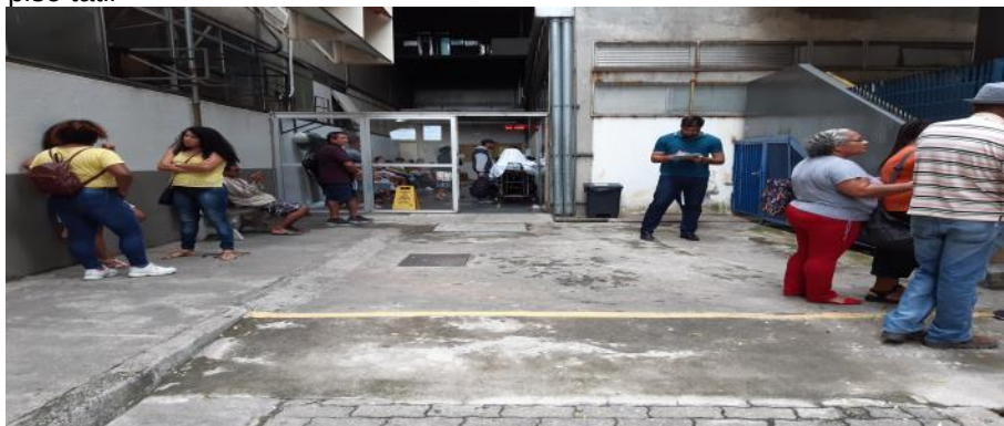
Figura 78 - Entrada do ambulatório com largura inadequada de 1,04 m e sem piso tátil
