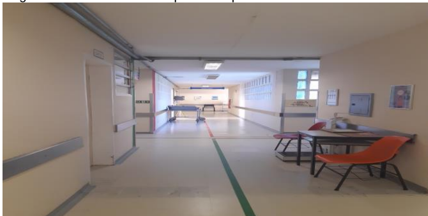
Figura 64 - Corredor do hospital sem piso tátil
