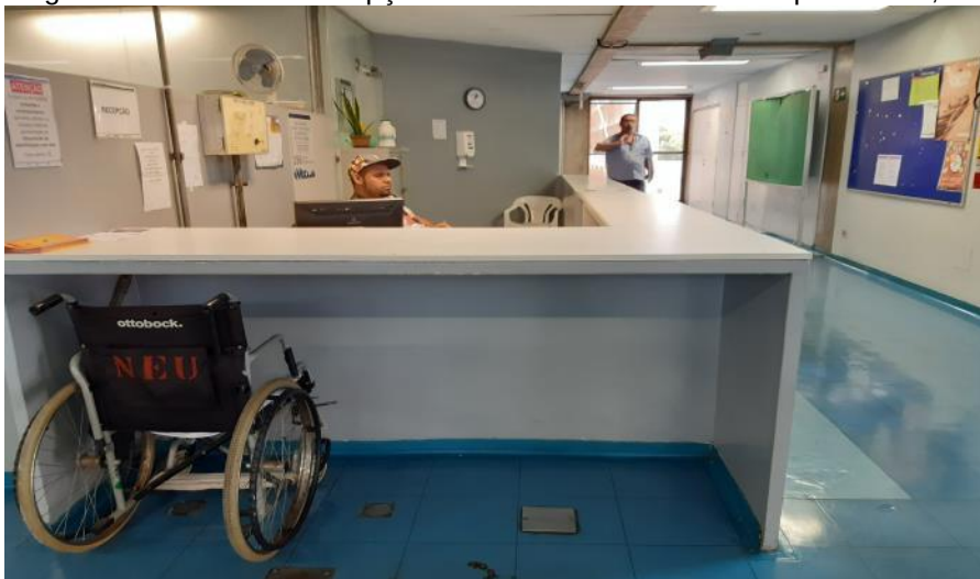
Figura 80 - Balcão da recepção de visitas com altura inadequada de 1,02 m
