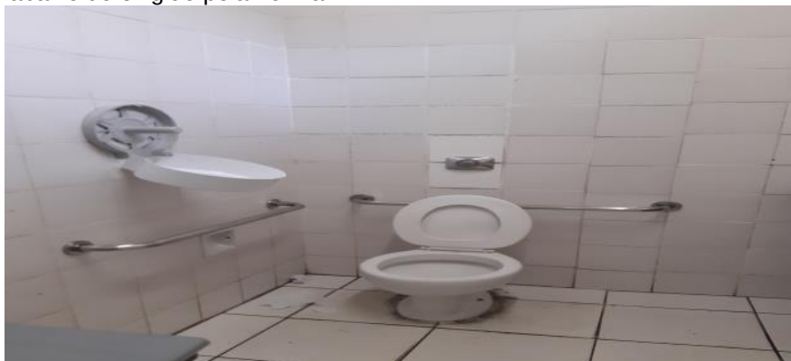
Figura 10 - Sanitário da área de espera do AMA – área de manobra adequada, porém a altura do assento sanitário e das barras de apoio está abaixo do exigido pela norma
