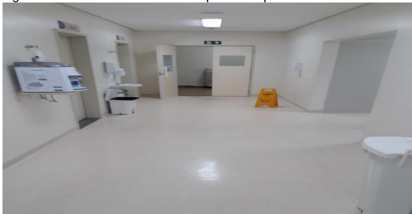
Figura 90 - Área reformada do hospital sem piso tátil
