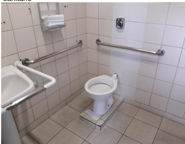
Figura 15 - Sanitário do Pronto Socorro sem assento sanitário
