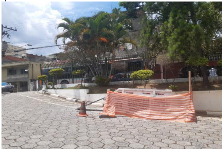
Figura 60 - Entrada externa do hospital sem corrimão e sem piso tátil
