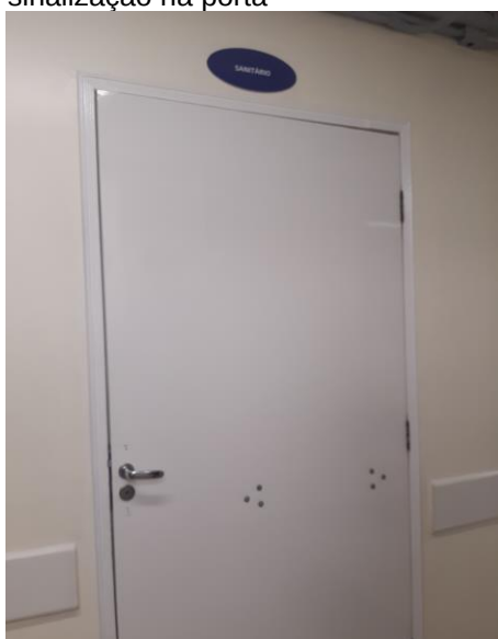
Figura 21 - Banheiro adaptado sem sinalização na porta
