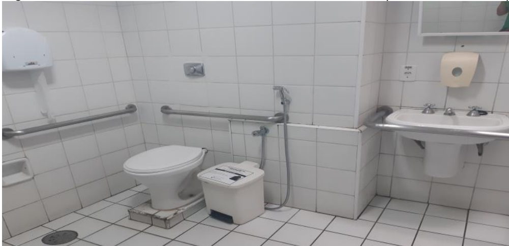
Figura 6 - Assento sanitário da clínica médica com altura inadequada de 0,48 m do piso
