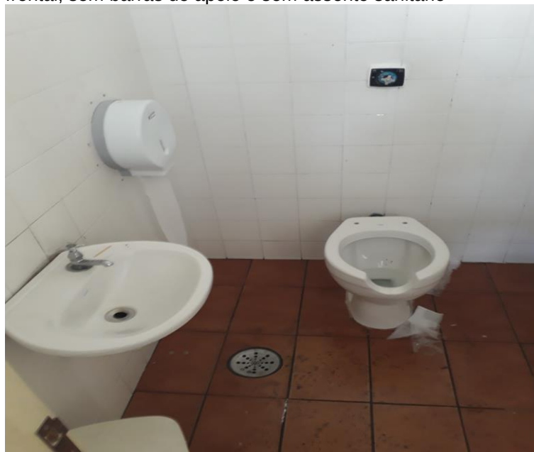
Figura 91 - Sanitário acessível do ambulatório com abertura frontal, sem barras de apoio e sem assento sanitário
