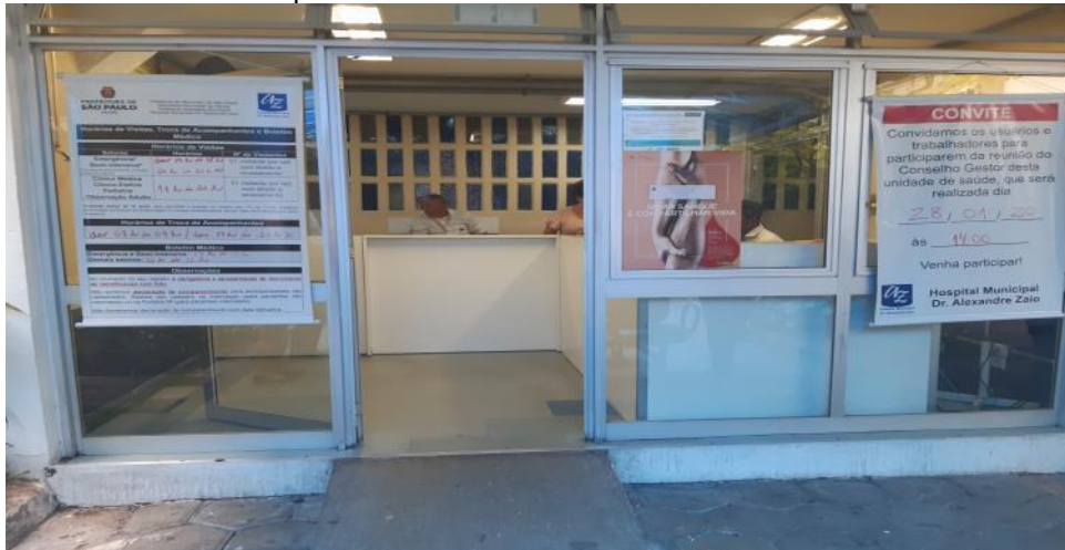
Figura 8 - Rampa da recepção de visitantes com largura inadequada de 0,88 m, sem corrimão e sem piso tátil
