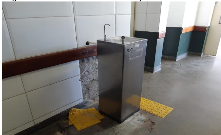
Figura 102 - Piso de alerta danificado junto ao bebedouro
