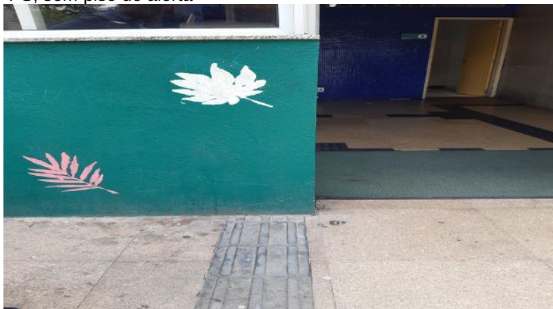
Figura 56 - Piso direcional ao encontro da parede da entrada do PS, sem piso de alerta
