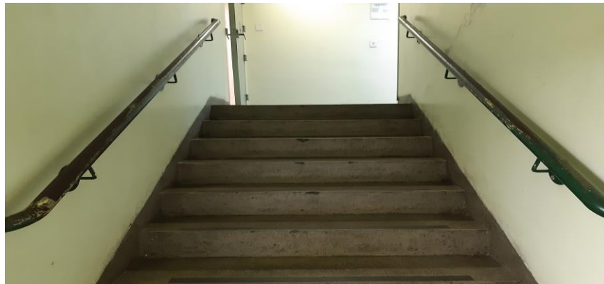
Figura 96 - Escada do hospital com corrimão de apenas uma altura e descontínuo
