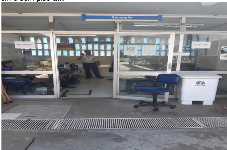
Figura 61 - Entrada de visitantes com largura inadequada de 0,90 cm e sem piso tátil
