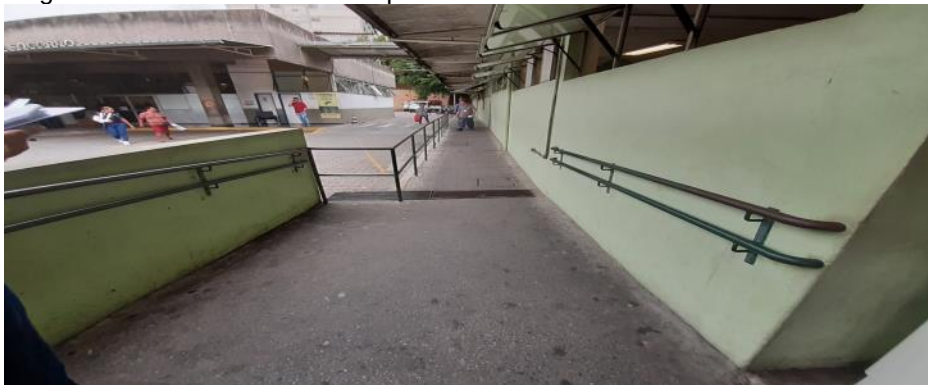
Figura 77 - Acesso ao PS sem piso tátil
