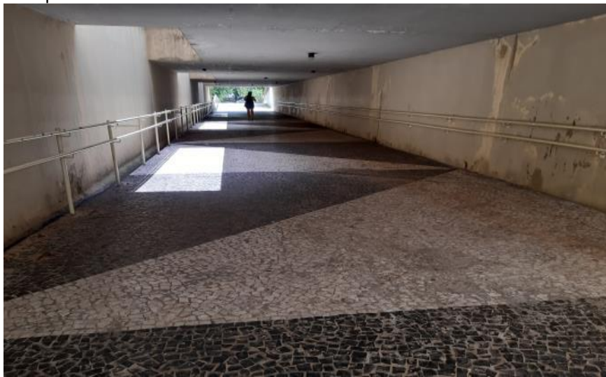
Figura 71 - Rampa de acesso ao ambulatório com inclinação acentuada e sem piso tátil
