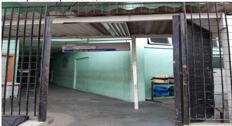
Figura 94 - Entrada de visitantes sem piso tátil e com largura inadequada da porta de 0,98 m
