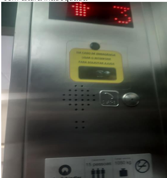
Figura 28 - Botão de Comunicação de Auxílio com altura inadequada
