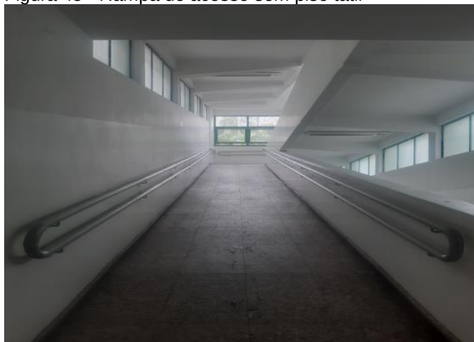
Figura 45 - Rampa de acesso sem piso tátil
