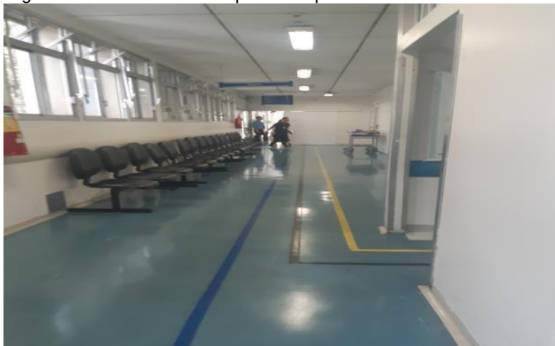
Figura 54 - Corredor do hospital sem piso tátil
