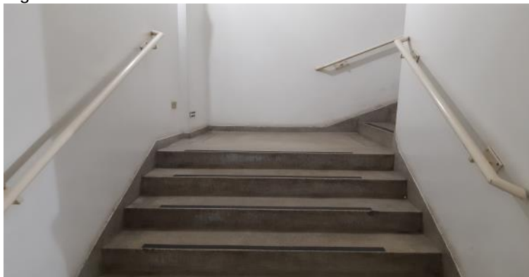
Figura 16 - Escada sem corrimão contínuo
