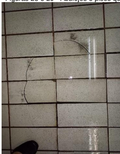
Figuras 28 e 29 - Azulejos e pisos quebrados
