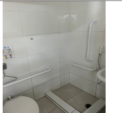
Foto 11 – Barras não substituídas em 19.02.24
