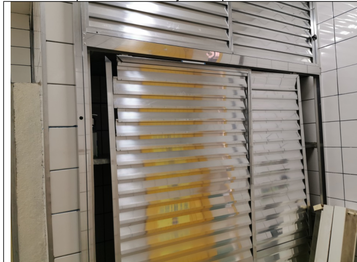
Foto 10 – Esquadrias sem vedação adequada em 2022
