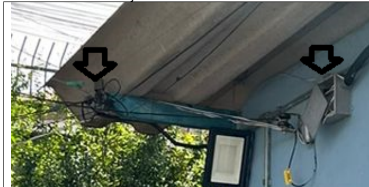
Foto 4 – Entrada de fiação na escola
