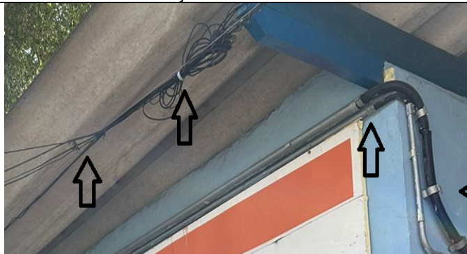
Foto 5 – Entrada de fiação embralhada
