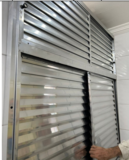
Foto 11 – Esquadrias sem vedação adequada em 2024
