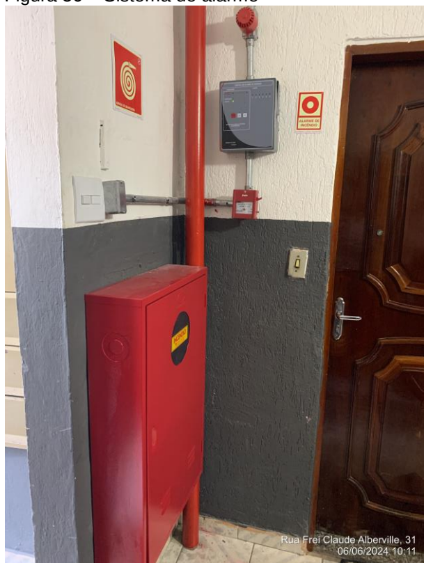
Figura 56 – Sistema de alarme
