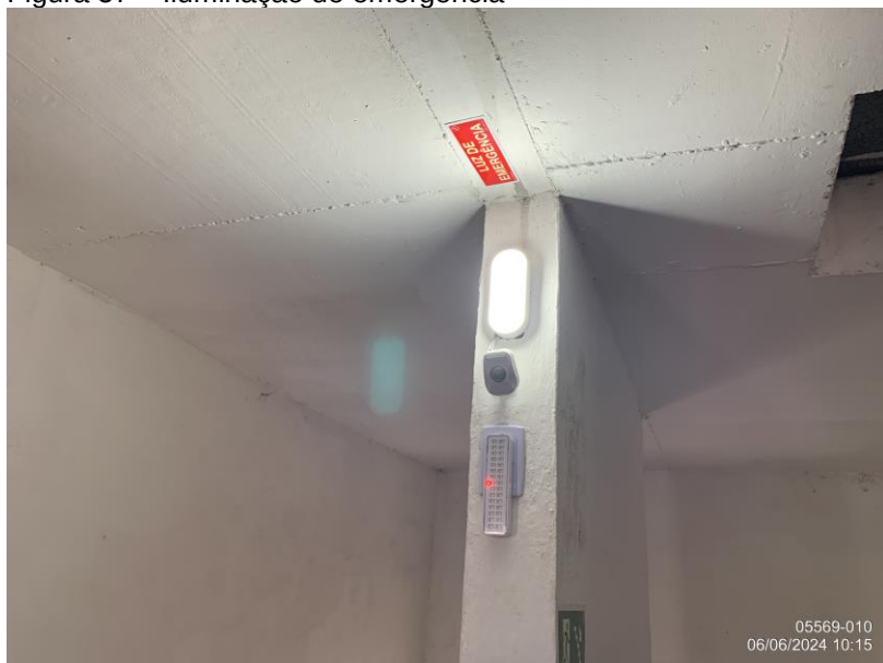
Figura 57 – Iluminação de emergência
