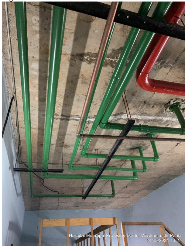
Figura 73 – Vista inferior do reservatório com barrilete
