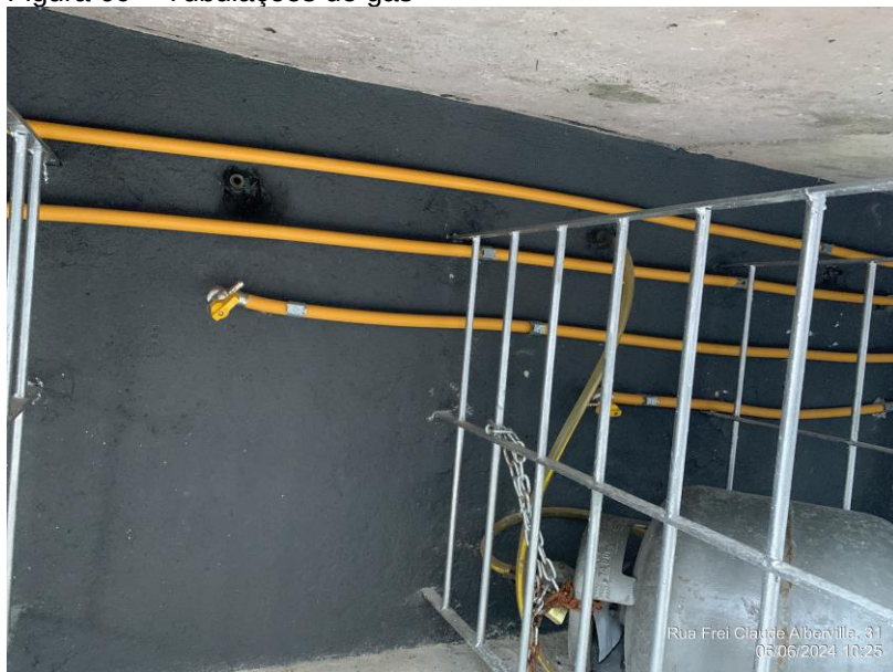
Figura 60 – Tubulações de gás
