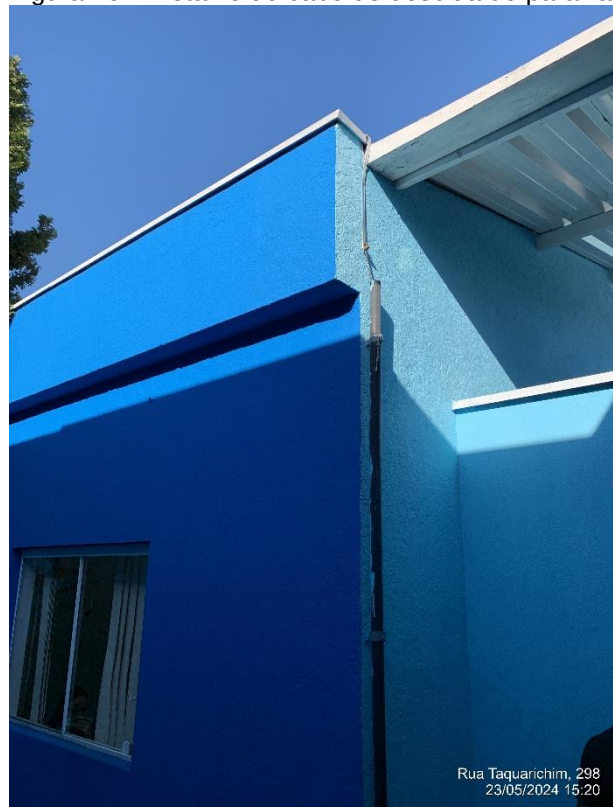
Figura 26 – Detalhe do cabo de descida do para-raio
