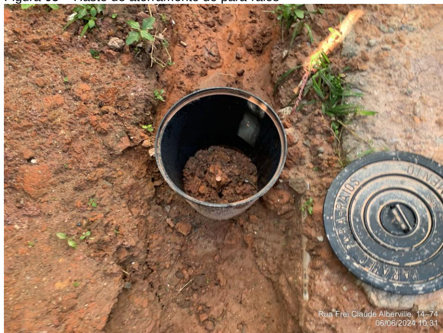
Figura 63 – Haste de aterramento do para-raios
