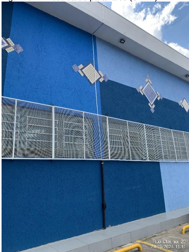
Figura 34 – Descida do para-raios (SPDA)
