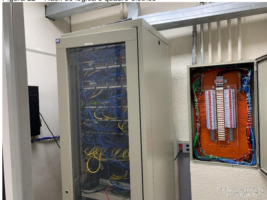
Figura 12 – Rack de lógica e quadro elétrico
