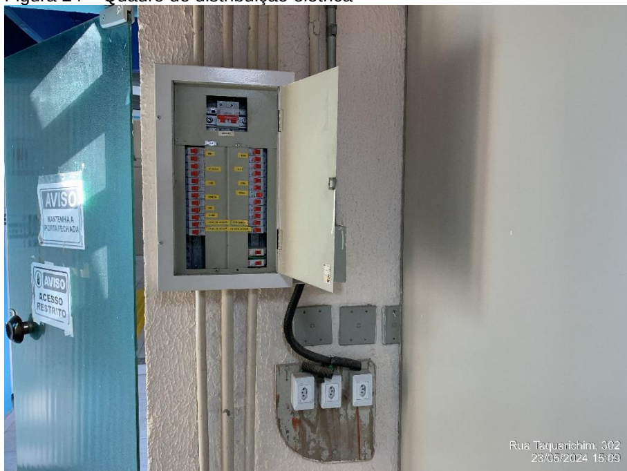
Figura 24 – Quadro de distribuição elétrica
