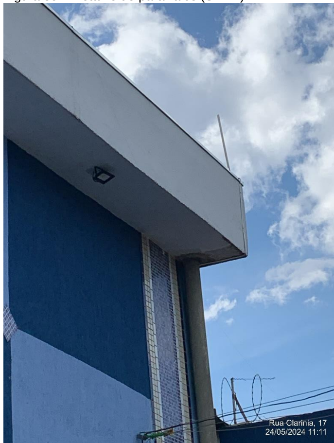
Figura 35 – Detalhe de para-raios (SPDA)
