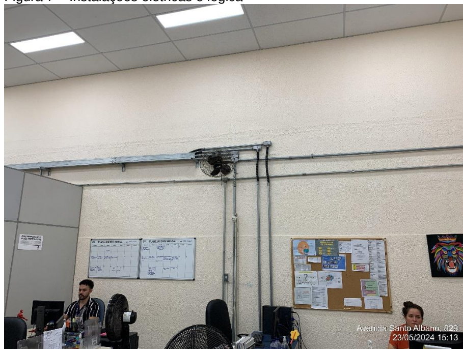
Figura 7 – Instalações elétricas e lógica
