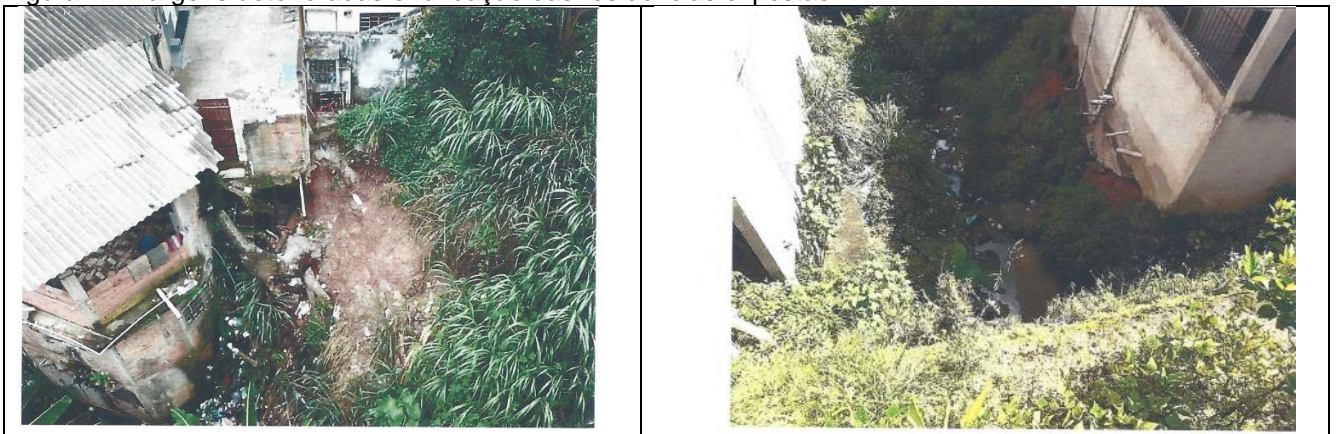
Figura 1 - Margens deterioradas e fundação das residências expostas
