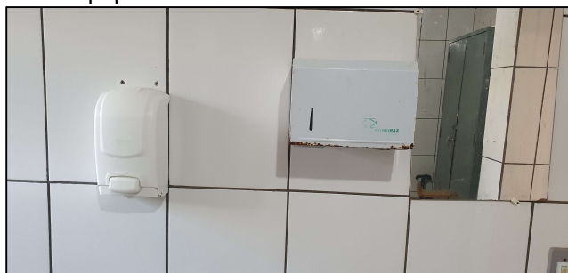
Figura 28 - Toalheiro danificado com corrosão e sem papel no banheiro masculino da UDO
