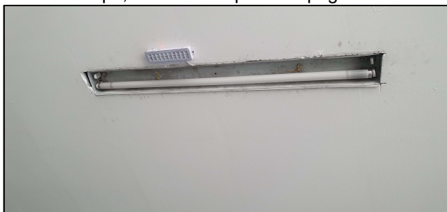
Figura 5 - Luminária sem sinal de que tenha sido limpa, faltando lâmpada e apagada
