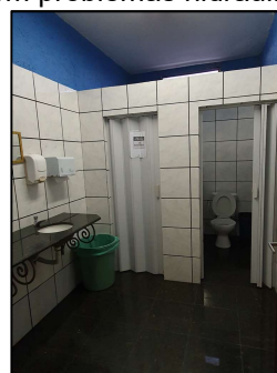
Figura 16 - Banheiro no térreo com box interditado, com problemas hidráulicos
