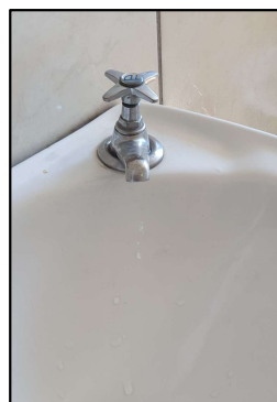
Figura 34 - Torneira com vazamento no banheiro masculino da UDO
