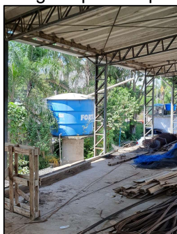
Figura 35 - Reservatório 10.000 litros de água para coleta de águas pluviais para reuso
