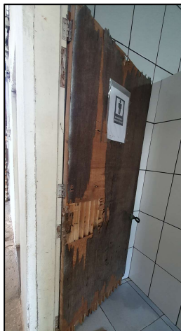
Figura 31 - Porta do banheiro danificada no depósito
