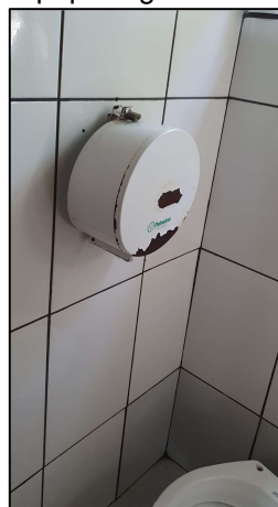
Figura 32 - Porta papel higiênico danificado/corroído
