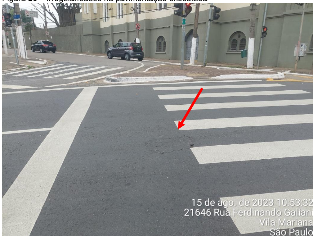
Figura 16 – Irregularidades na pavimentação executada
