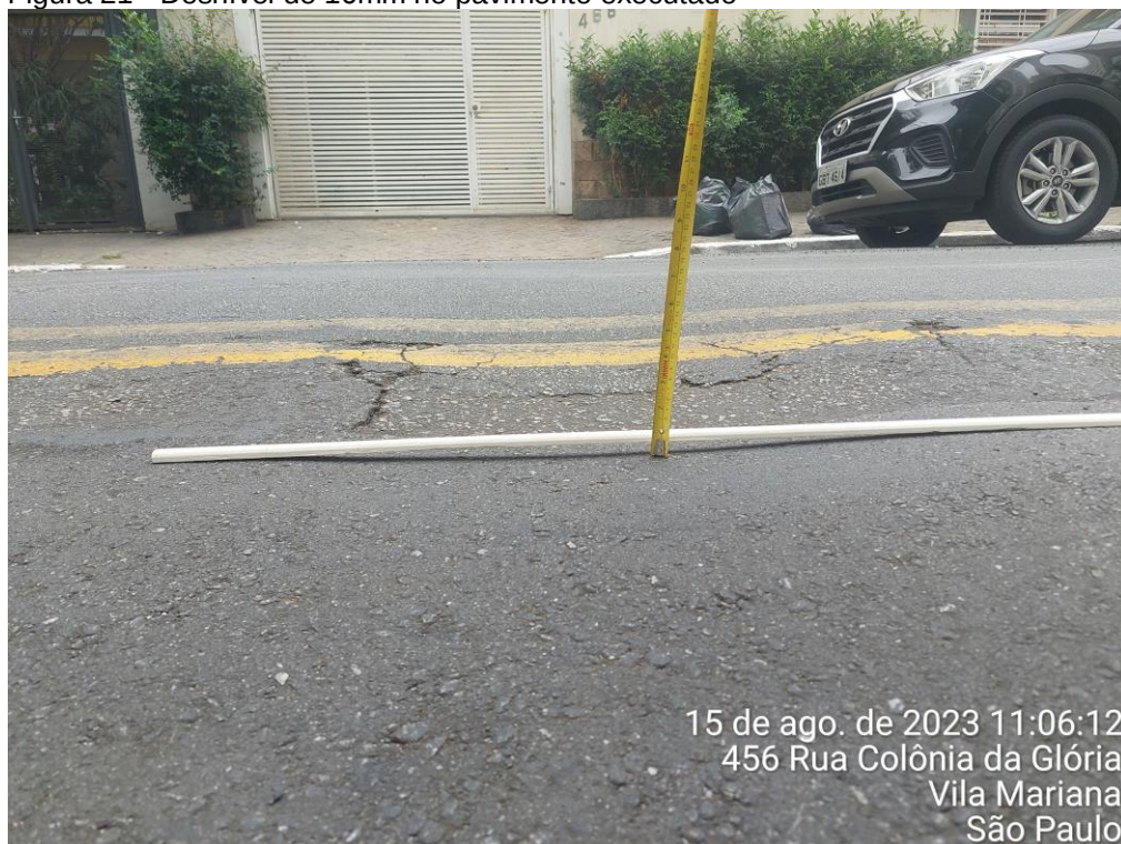
Figura 21 - Desnível de 16mm no pavimento executado
