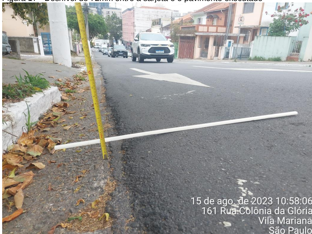
Figura 17 - Desnível de 72mm entre a sarjeta e o pavimento executado
