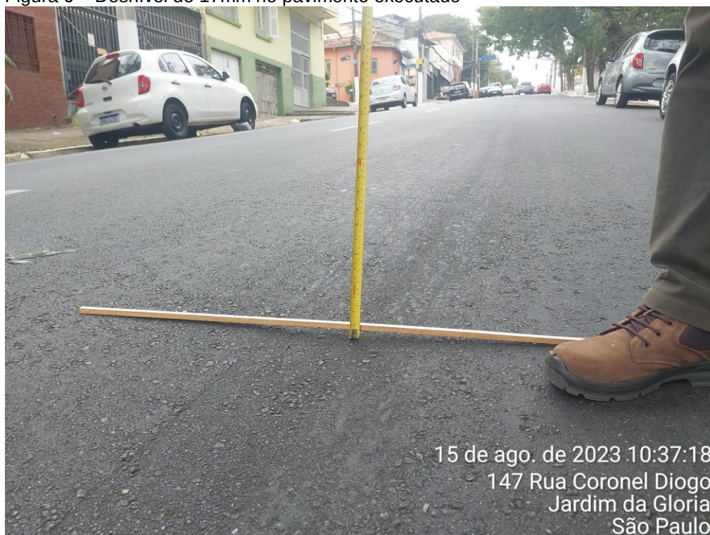
Figura 6 – Desnível de 17mm no pavimento executado
