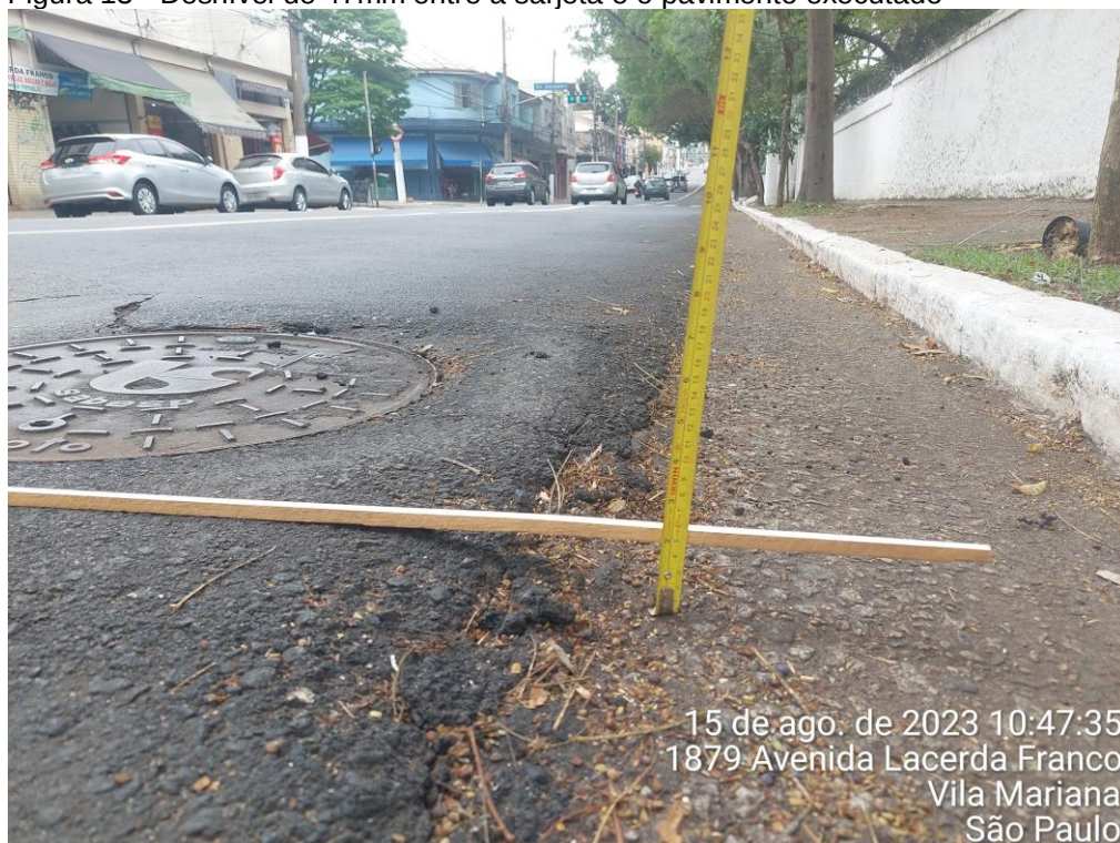
Figura 13 - Desnível de 47mm entre a sarjeta e o pavimento executado
