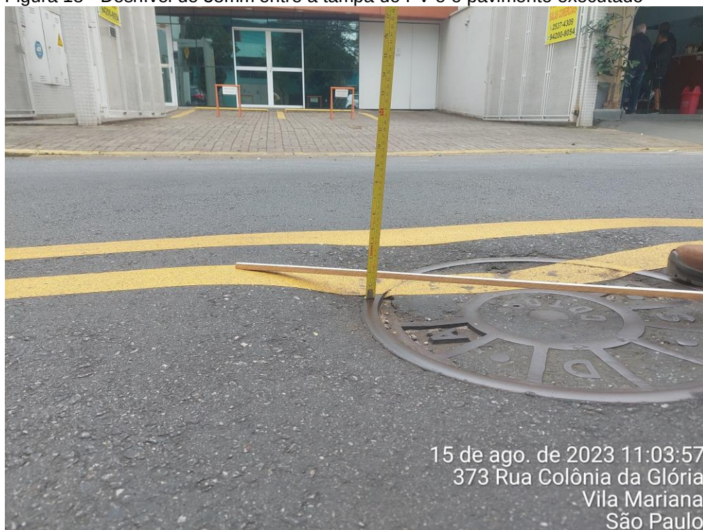
Figura 18 - Desnível de 38mm entre a tampa do PV e o pavimento executado
