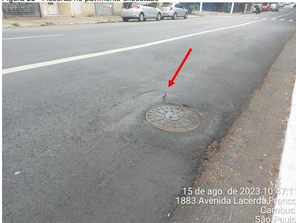
Figura 11 - Fissuras no pavimento executado
