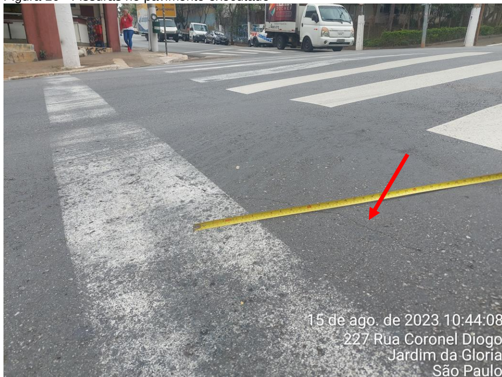
Figura 10 - Fissuras no pavimento executado
