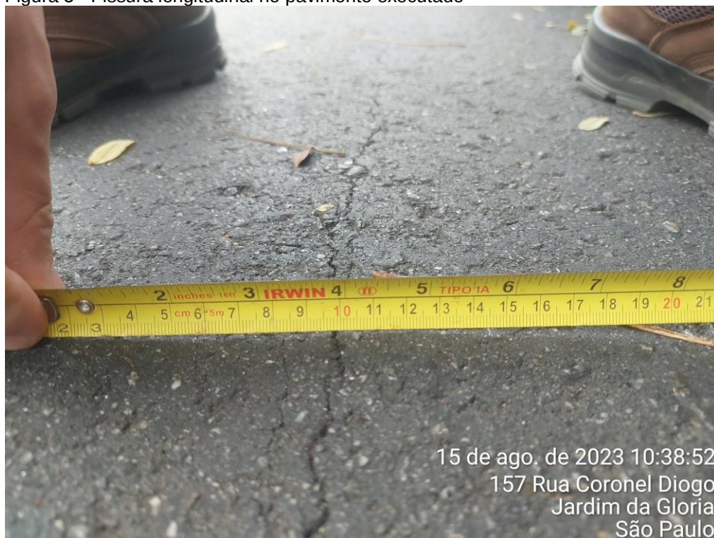
Figura 5 - Fissura longitudinal no pavimento executado
