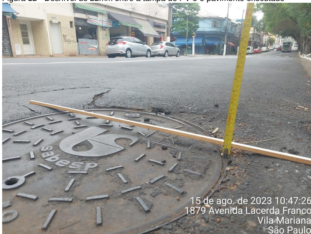
Figura 12 - Desnível de 22mm entre a tampa do PV e o pavimento executado
