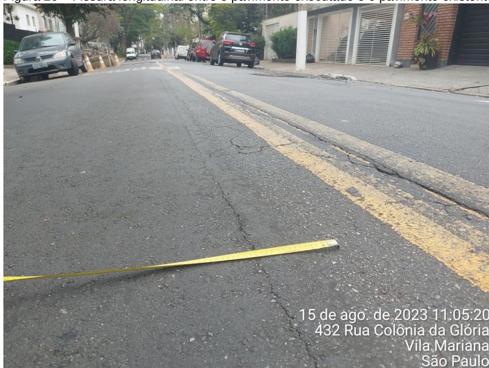
Figura 20 – Fissura longitudinal entre o pavimento executado e o pavimento existente
