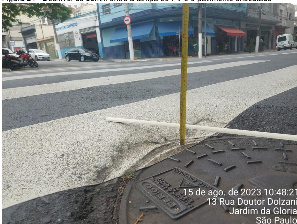
Figura 14 - Desnível de 50mm entre a tampa do PV e o pavimento executado
