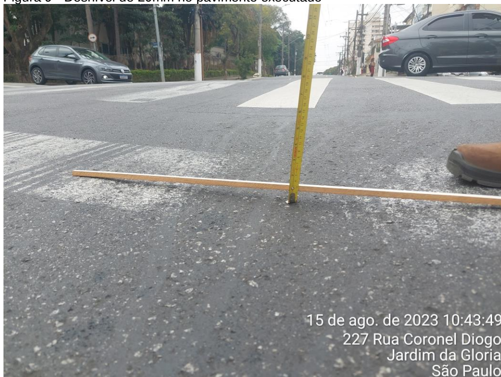
Figura 9 - Desnível de 20mm no pavimento executado
