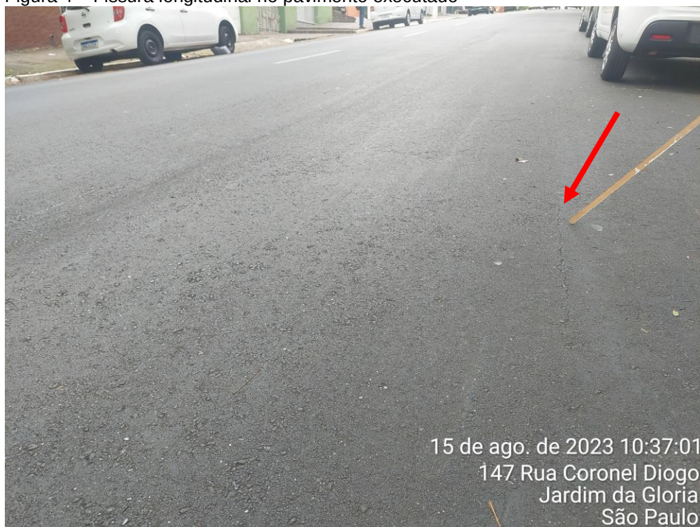
Figura 4 – Fissura longitudinal no pavimento executado
