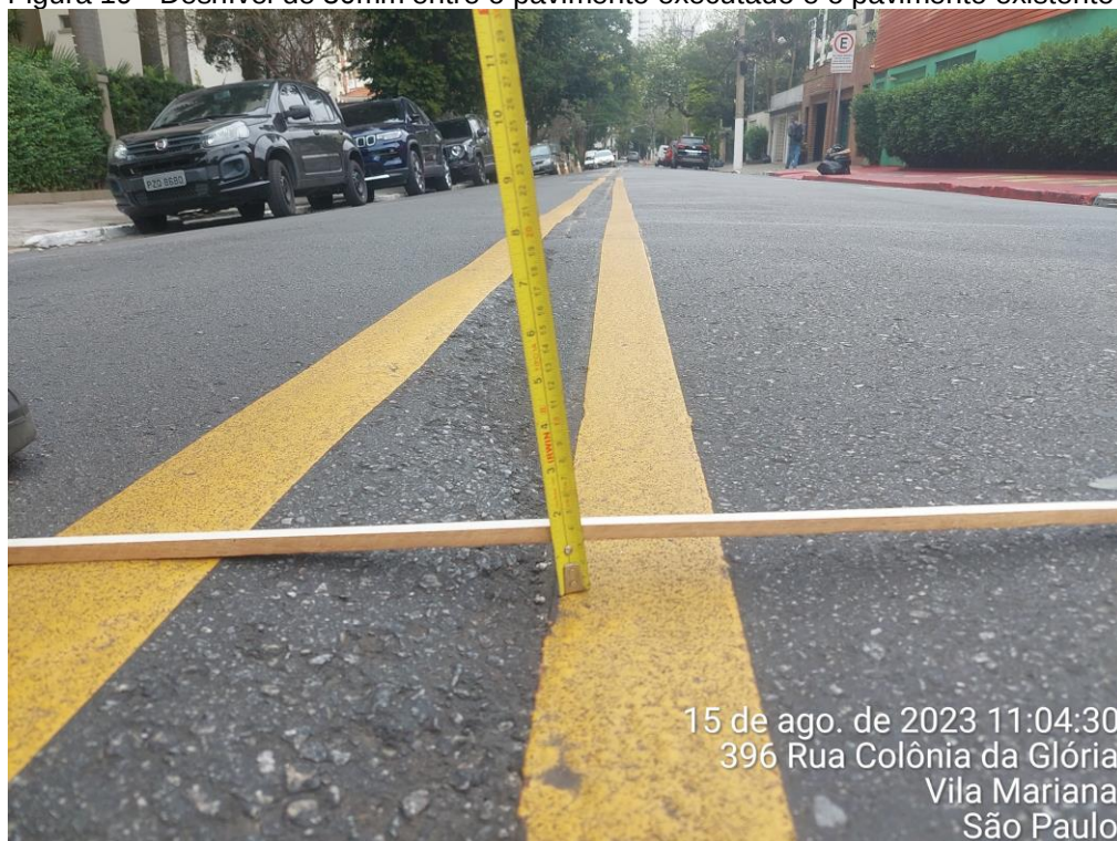
Figura 19 - Desnível de 30mm entre o pavimento executado e o pavimento existente
