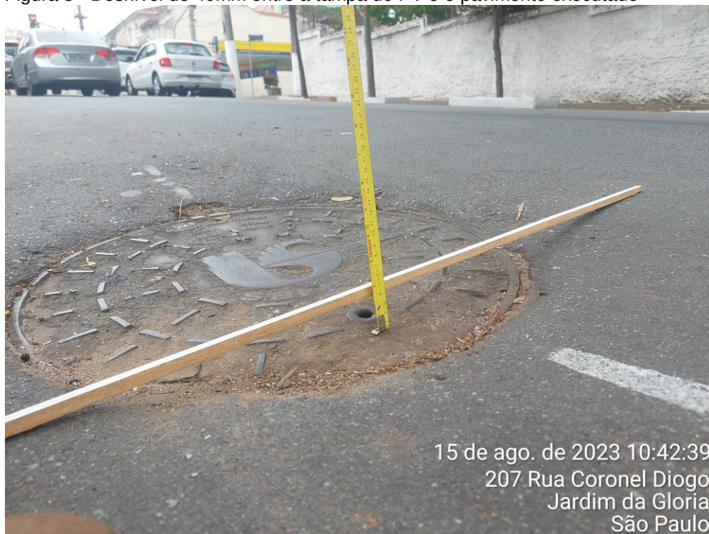
Figura 8 - Desnível de 40mm entre a tampa do PV e o pavimento executado
