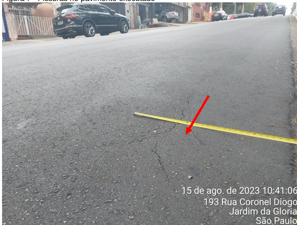
Figura 7 - Fissuras no pavimento executado
