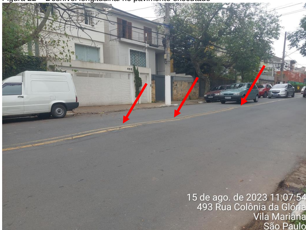
Figura 22 – Desnível longitudinal no pavimento executado
