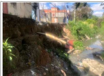
Vista do avanço da área erodida sobre as edificações da rua Francisco de Holanda
