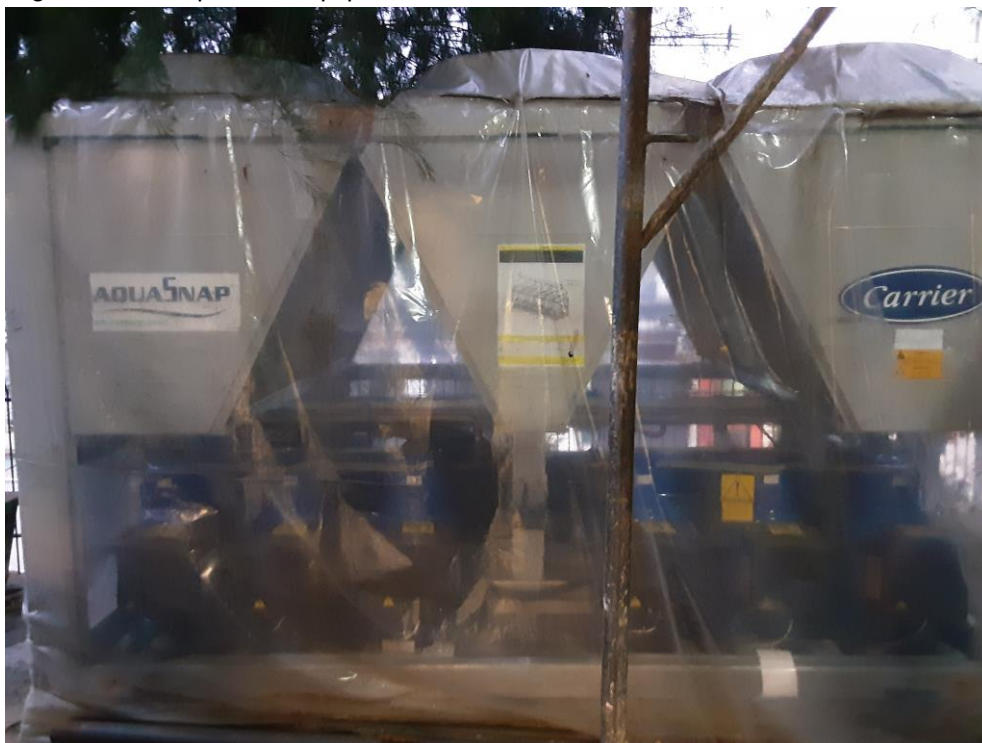
Figura 26 – Máquinas e equipamentos externos do sistema de ar-condicionado.
