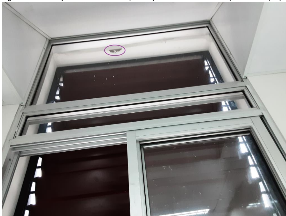
Figura 97 – Serviço a refazer: instalação de janela mal executada (vide destaque).
