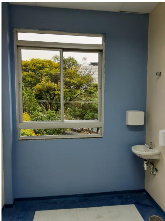
Figura 96 – Janela instalada fora do padrão.
