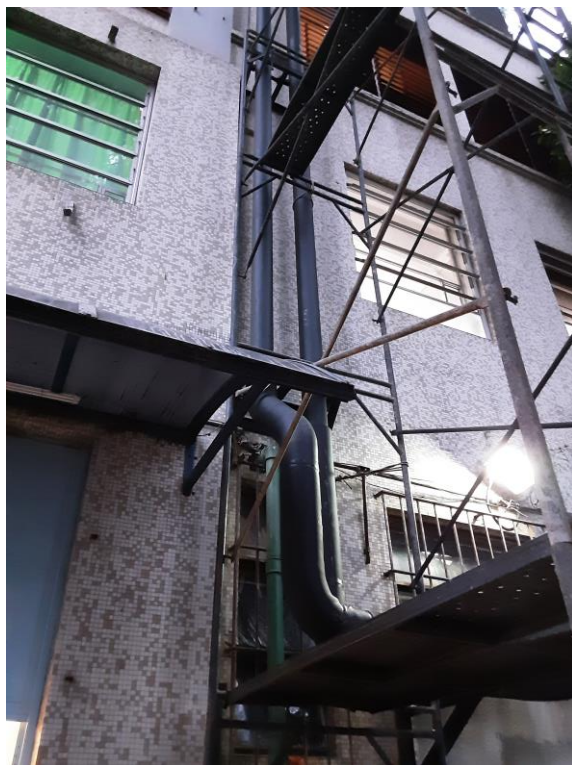
Figura 27 – Dutos - sistema de ar-condicionado.
