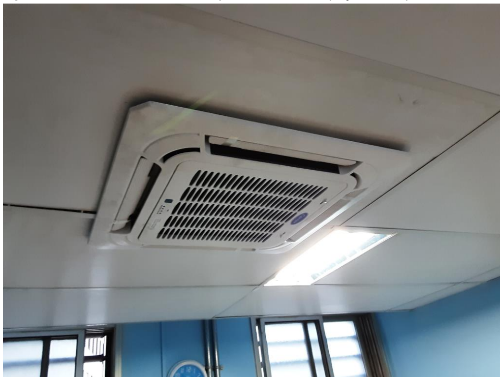
Figura 44 – Ar-condicionado central já instalada em espaço do Hospital.
