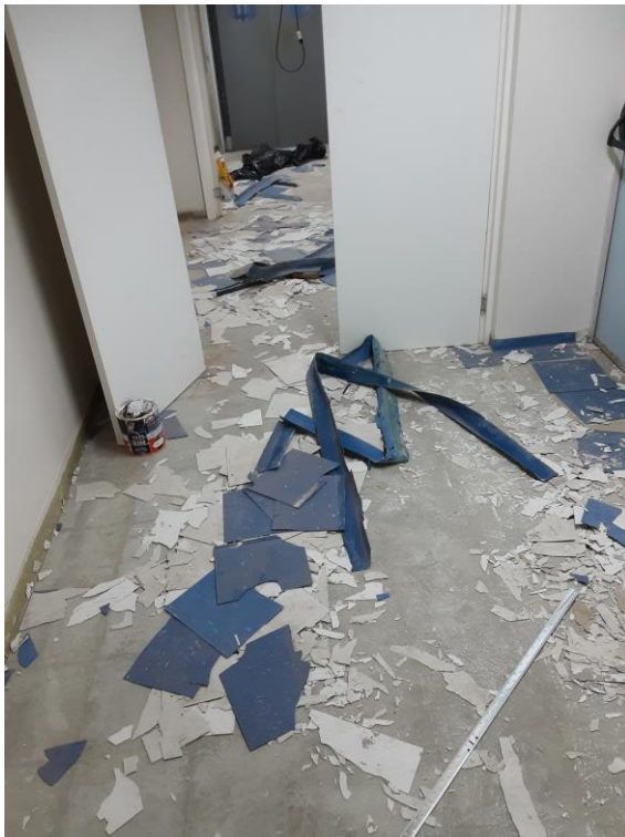
Figura 98 – A refazer: piso colocado errado.
