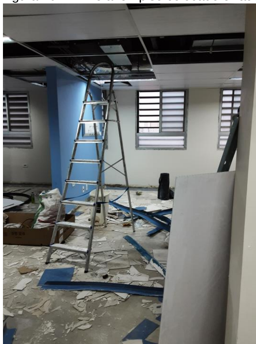
Figura 101 – A refazer: piso colocado errado.
