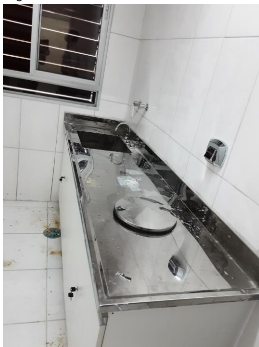
Figura 67 – Área com reforma não concluída.
