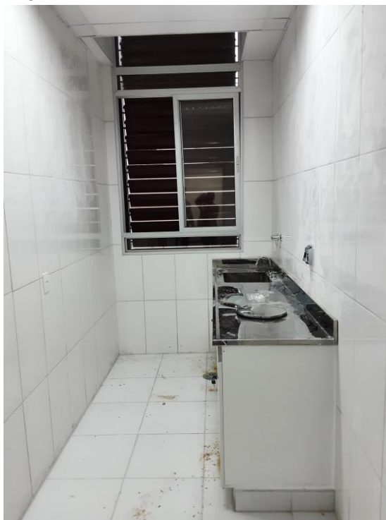
Figura 66 – Área com reforma não concluída.
