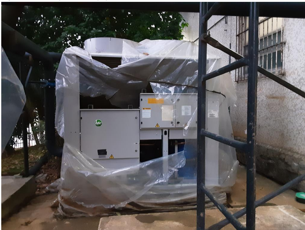
Figura 25 – Máquinas e equipamentos externos do sistema de ar-condicionado.
