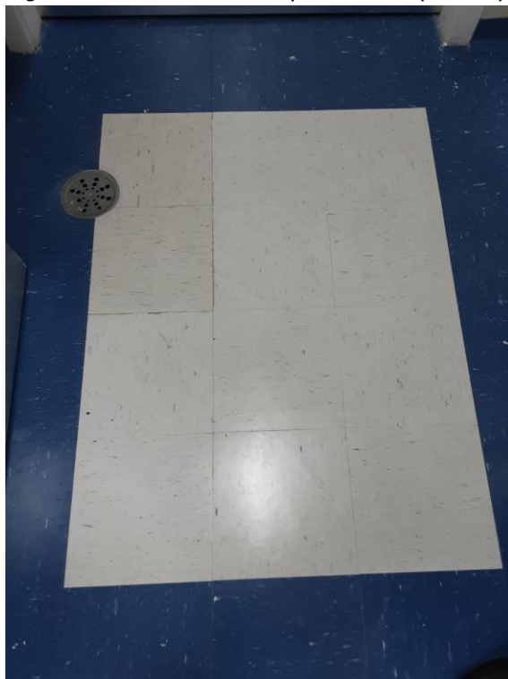
Figura 94 – Tonalidade do piso errada (refazer).
