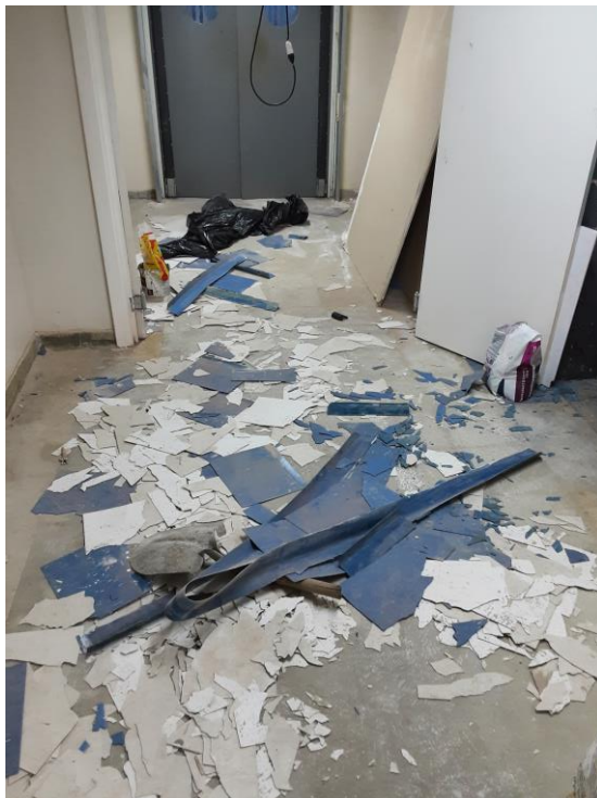
Figura 99 – A refazer: piso colocado errado.
