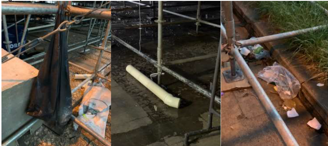
Figura 2 – Detritos encontradas na Estação da Sé
