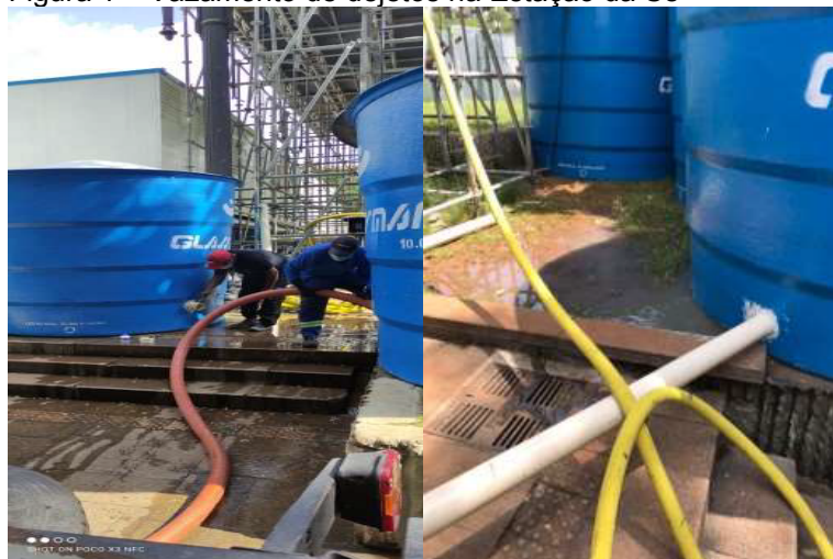
Figura 1 – Vazamento de dejetos na Estação da Sé
