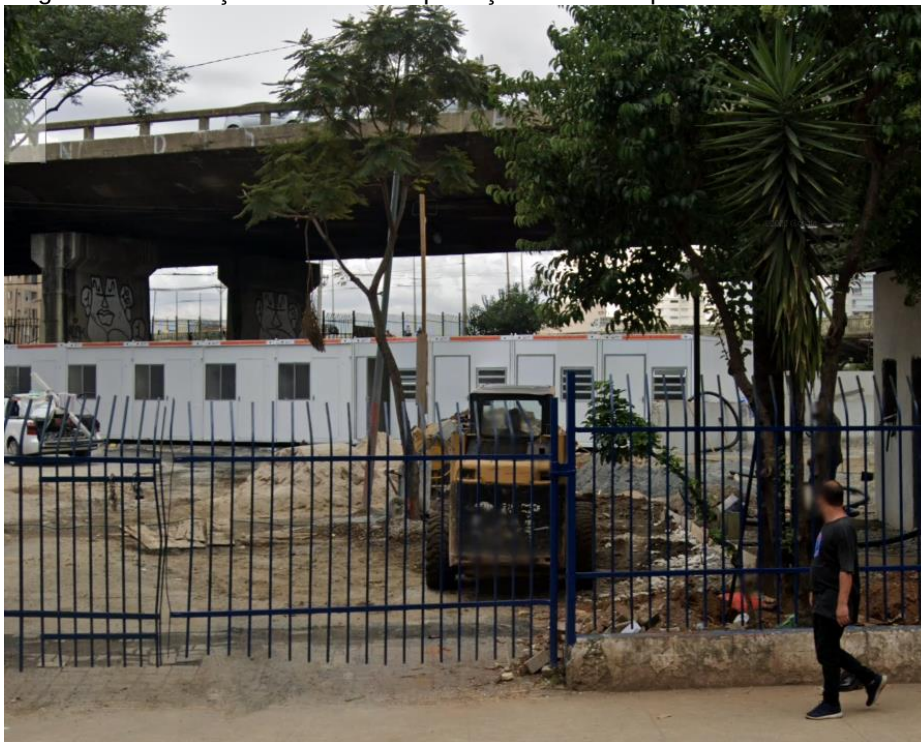
Figura 4 – Execução de obra sem proteção dos exemplares
