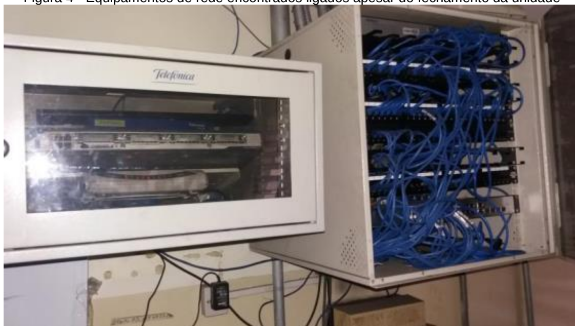
Figura 4 - Equipamentos de rede encontrados ligados apesar do fechamento da unidade
