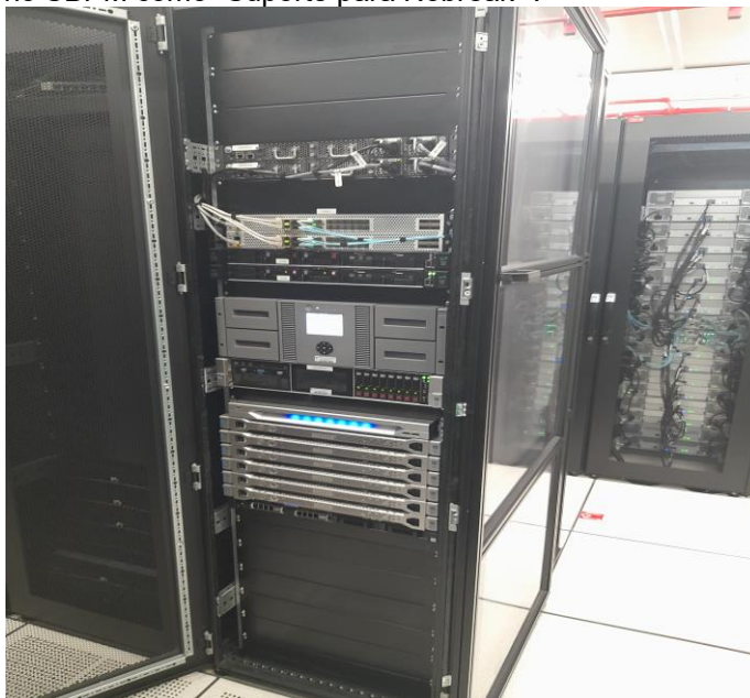
Figura 6 – Estrutura de Backup registrada indevidamente no SBPM como “Suporte para Nobreak” .
